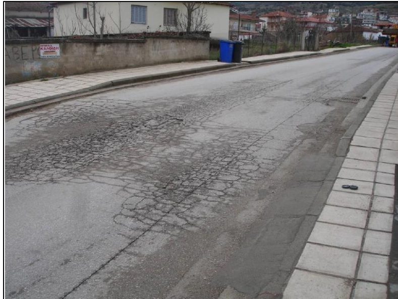
Εικόνα 6. Ζώνη παραμόρφωσης σε εγκάρσιο στην εθνική οδό δρόμο (Chatzipetros et al 2005)
