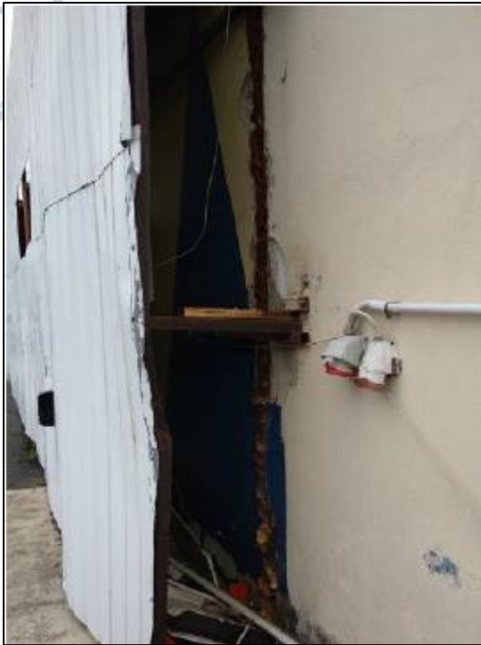
Εικόνα 4. Αποκόλληση ένωσης της τοιχοποιίας με το σκελετό του κτιρίου (Chatzipetros,2019)
