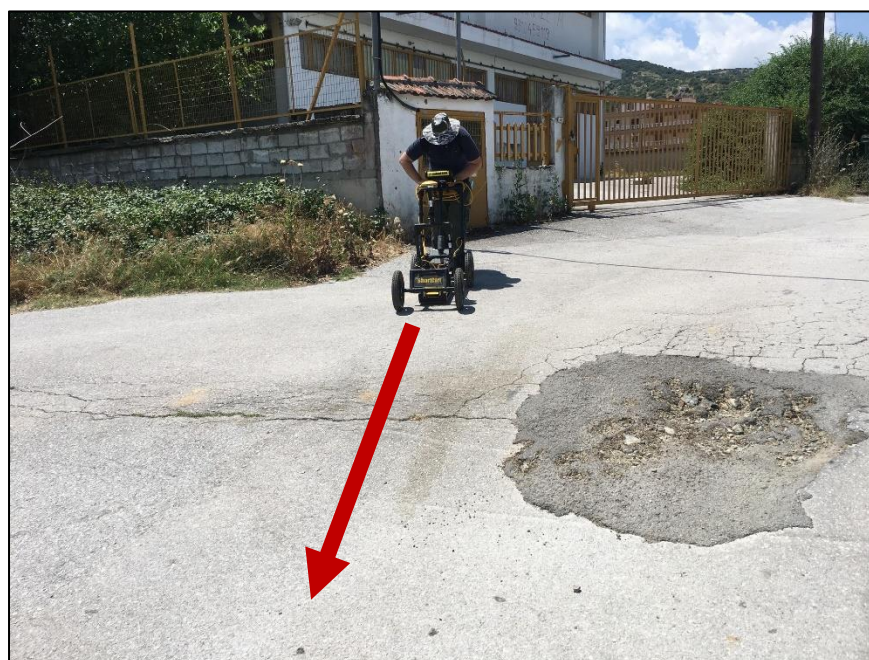
Εικόνα 156. Διέλευση Γεωραντάρ από την εδαφική ρωγμωση η οποία προκάλεσε παραμόρφωση στο οδόστρωμα
