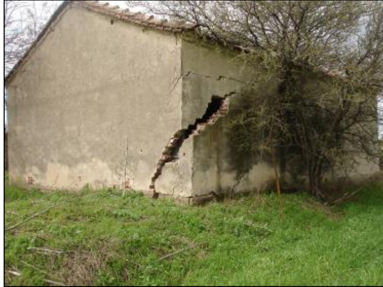
Εικόνα 10. Ανατολική άποψη του κτιρίου της θέσης 4 όπου διακρίνεται η παραμόρφωση της ΒΑ πλευράς του (Chatzipetros et al.2005)
