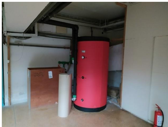
Εικόνα 6: Δοχείο αδράνειας στο υπόγειο του κτιρίου Υδραυλικής
