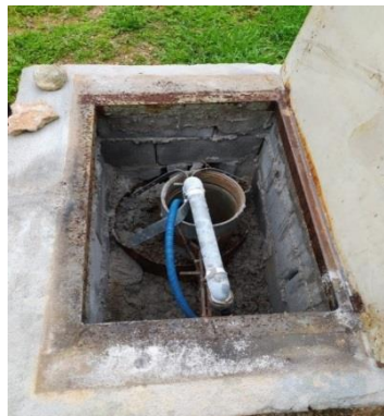
Εικόνα 7: Κεφαλή υδρογεώτρησης του ανοικτού συστήματος ΓΑΘ στον προαύλιο χώρο του κτιρίου Υδραυλικής
