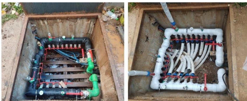
Εικόνα 13: Φρεάτιο συλλεκτών προσαγωγής-επιστροφής
