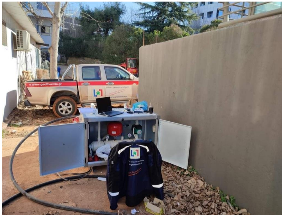
Εικόνα 15. Εξοπλισμός για τη δοκιμή θερμικής απόκρισης στο κτίριο Υδραυλικής ΑΠΘ
