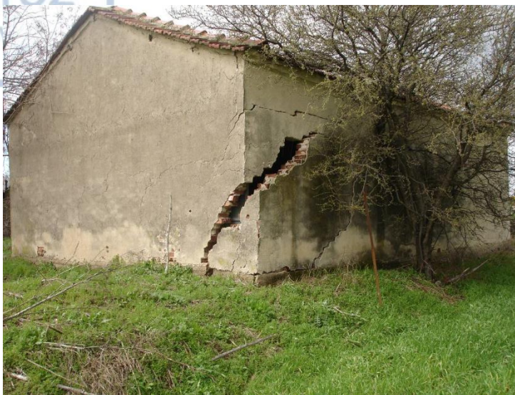
Εικόνα 4. Άποψη κτιρίου στη θέση 4, από τα Α. Διακρίνονται οι μεγάλες παραμορφώσεις της ΒΑ πλευράς του κτιρίου, καθώς και το χαμηλό πρανές κατά μήκος της Β πλευράς.
