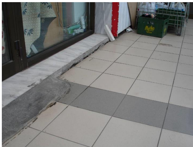
Εικόνα 1. Η διάρρηξη στον προθάλαμο του καταστήματος "ΕΓΝΑΤΙΑ". Διακρίνεται η μετατόπισή της και η προσπάθεια επιδιόρθωσής της.
