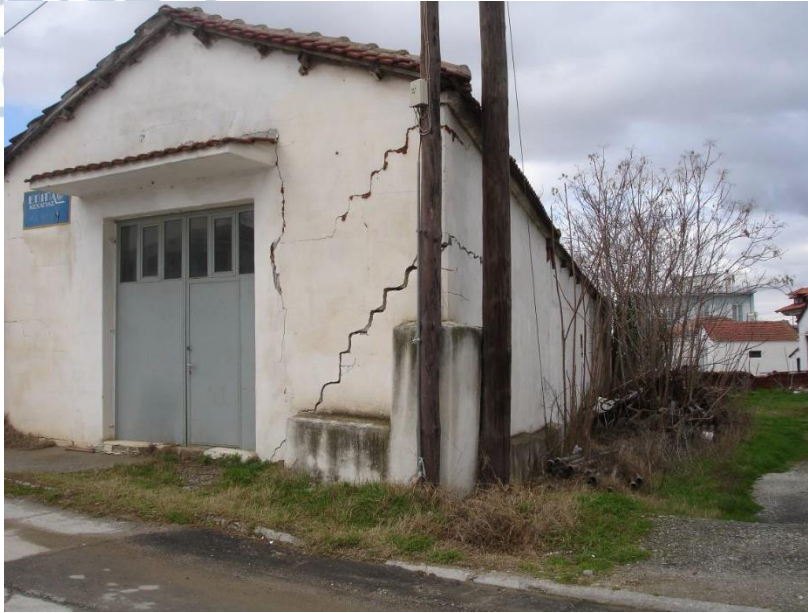
Εικόνα 6. Γενική άποψη της παραμόρφωσης σε αποθήκη στη θέση 3.
