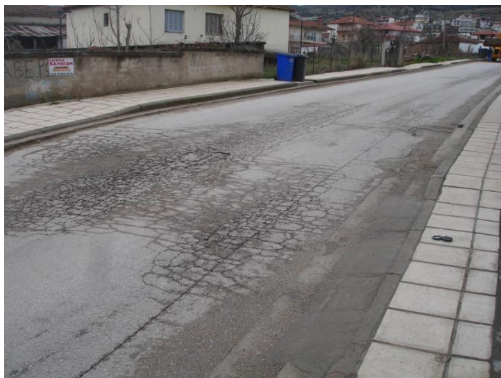
Εικόνα 3. Ζώνη παραμόρφωσης σε δρόμο εγκάρσιο της εθνικής οδού.
