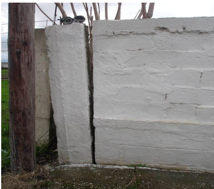
Εικόνα 5. Αποκόλληση κολώνας σε εξωτερικό φράχτη.
