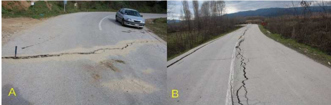
Σχήμα 5-5. Επιφανειακές ρωγμές επαρχιακής οδού.
