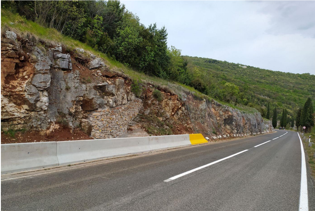
Εικόνα 2.18 Χρήση βραχοπαγίδας (αριστερά) και μεταλλικών πλεγμάτων (δεξιά) για την συγκράτηση βραχωδών υλικών. (Πηγή: geotech )
