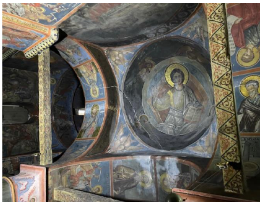
Εικόνα 9: Εμφανής ρηγμάτωση στο τόξο της Λιτής.
