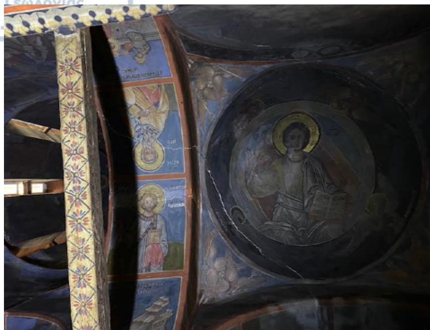
Εικόνα 11: Εμφανής ρηγμάτωση στο φουρνικό της Λιτής.
