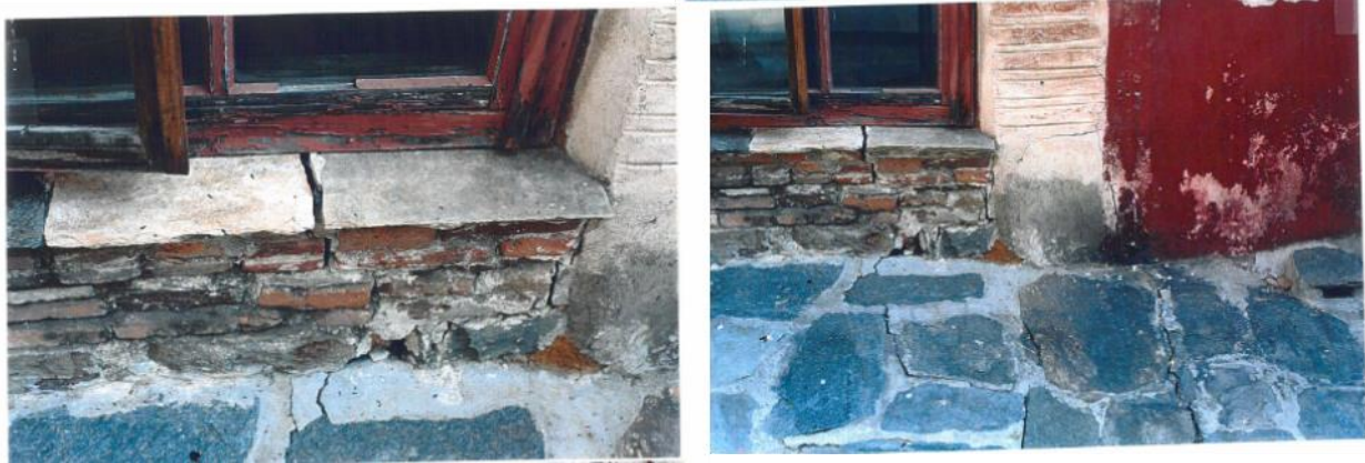
Εικόνα 5: Εμφάνιση ρωγμών στο χαμηλό στηθαίο του Εζωνάρθηκα κάτω από τα κουφώματα. Είναι διακριτή η διάβρωση των κουφωμάτων.
