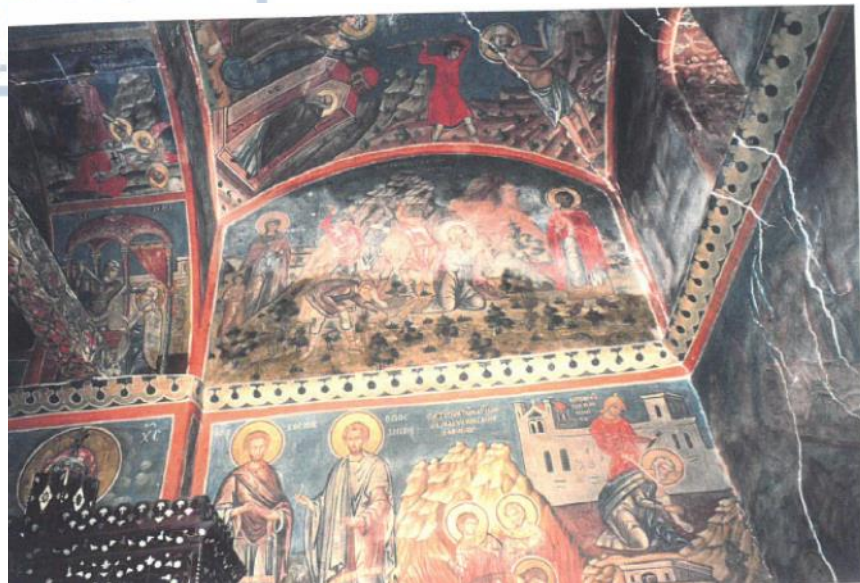
Εικόνα 10: Έντονες ρωγμές στο εσωτερικό των σταυροθολίων της Λιτής με σημαντικό εύρος.
