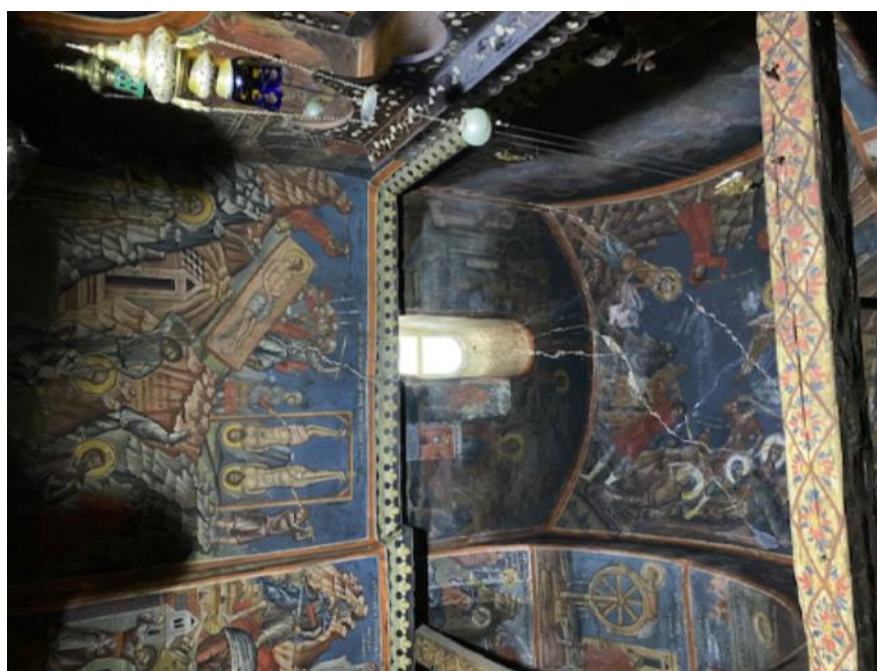
Εικόνα 12: Εμφανής ρηγμάτωση Ανατολικού Σταυροθολίου Λιτής.
