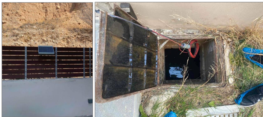
Εικόνα 22: Η υδρομάστευση της πηγής στο καινούργιο λουτροθεραπευτήριο (Sra) Λουτρακίου Κορινθίας και ο τηλεμετρικός σταθμός παρακολούθησης
