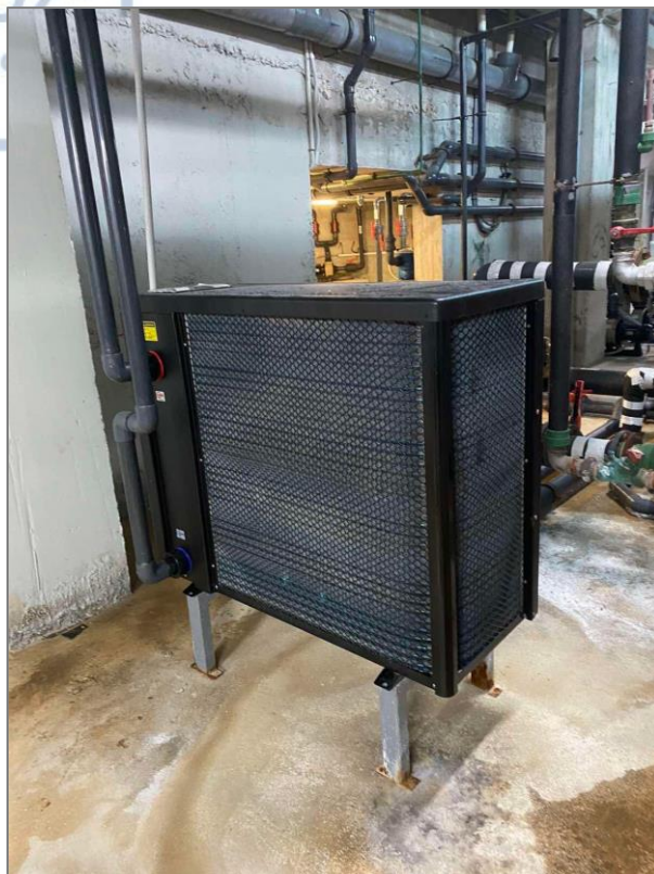
Εικόνα 36: Αντλία θερμότητας για τη θέρμανση των νερών στο νέο υδροθεραπευτήριο
