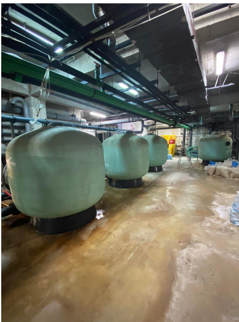
Εικόνα 35: Φίλτρα άμμου για τη συγκράτηση των φερτών υλικών στο μηχανοστάσιο του νέου υδροθεραπευτηρίου
