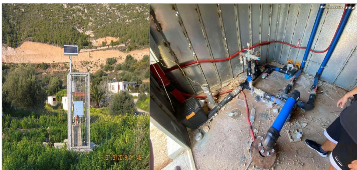
Εικόνα 23: Αριστερά ο τηλεμετρικός σταθμός παρακολούθησης ερευνητικής γεώτρησης (Χατζηγιάννης, 2010), δεξιά η γεώτρηση Γ-IAM1
