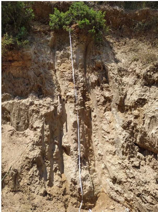
Σχήμα 16: Η πλήρης έκταση την KMN-2 στο πρανές.
