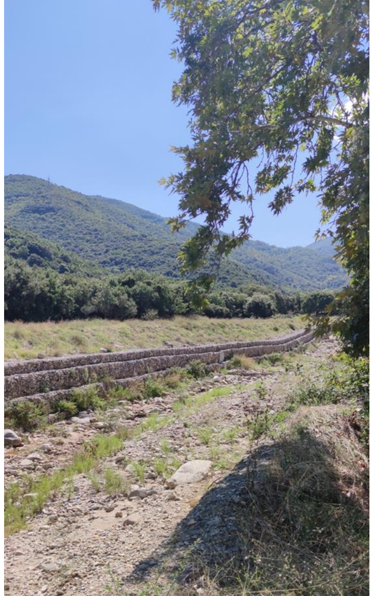
Εικόνα 28: Η κεντρική κοίτη του χείμαρρου 3 «Φάληρο» με τεχνητές αναβαθμίδες ( από σκυρόδεμα και ογκόλιθους) για τον έλεγχο της ροής του ποταμού και την αποφυγή πλευρικής διάβρωσης.
