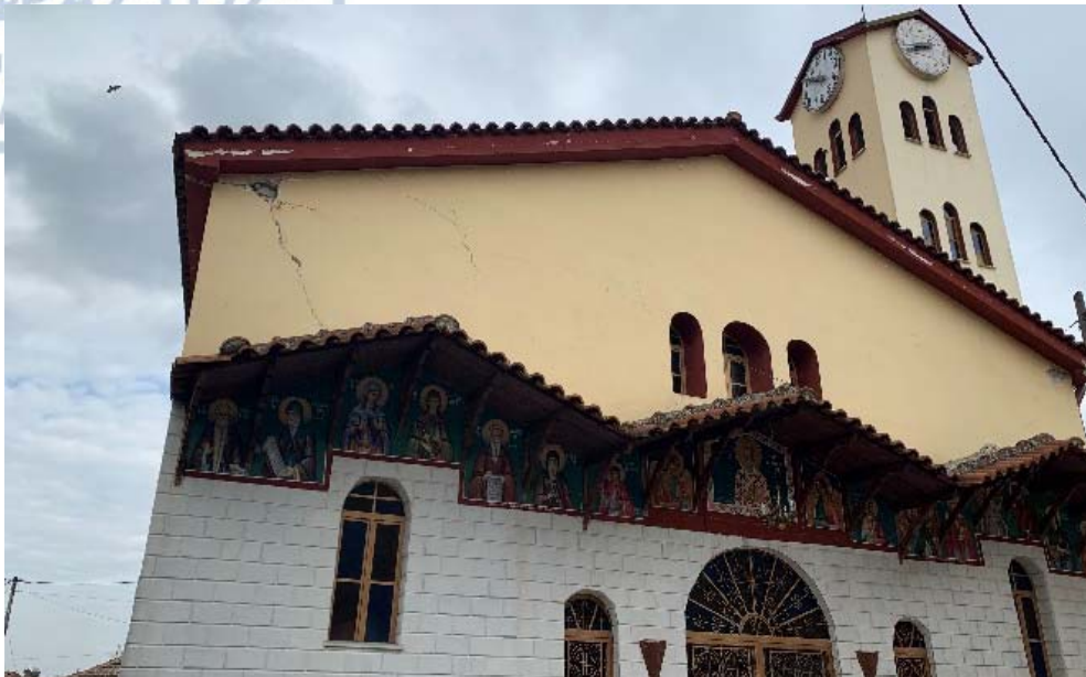
Σχήμα 2.3 : Ρωγμή στον Ιερό Ναό Αγίου Νικολάου στο Δαμάσι.
