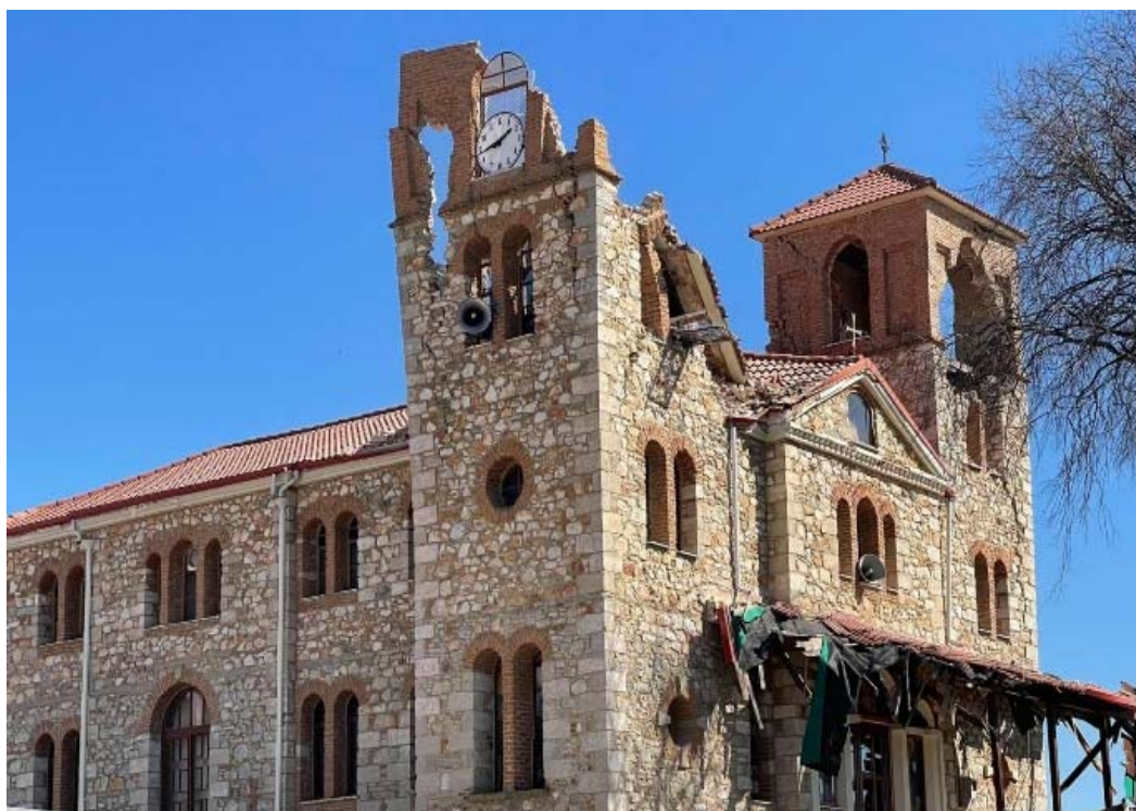
Σχήμα 2.4 : Μερική κατάρρευση καμπαναριού στον Ιερό Ναό Αγίου Δημητρίου στο Μεσοχώρι.
