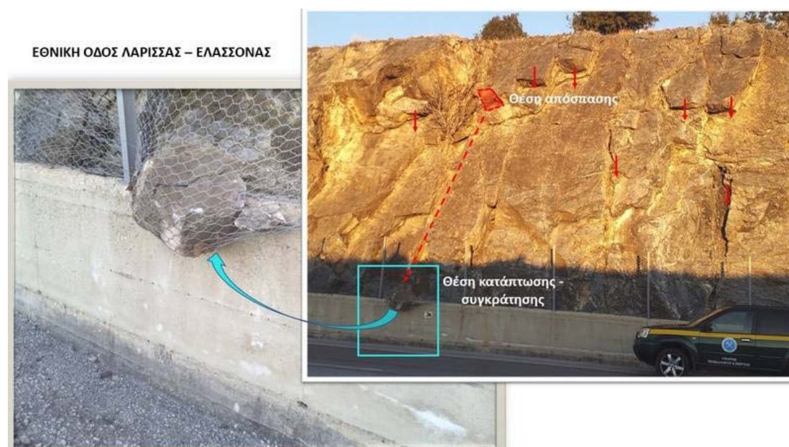
Σχήμα 2.7 : Θέση Μελούνα, εθνική οδός Λάρισας–Ελασσόνας, πτώσεις μαρμάρων.
