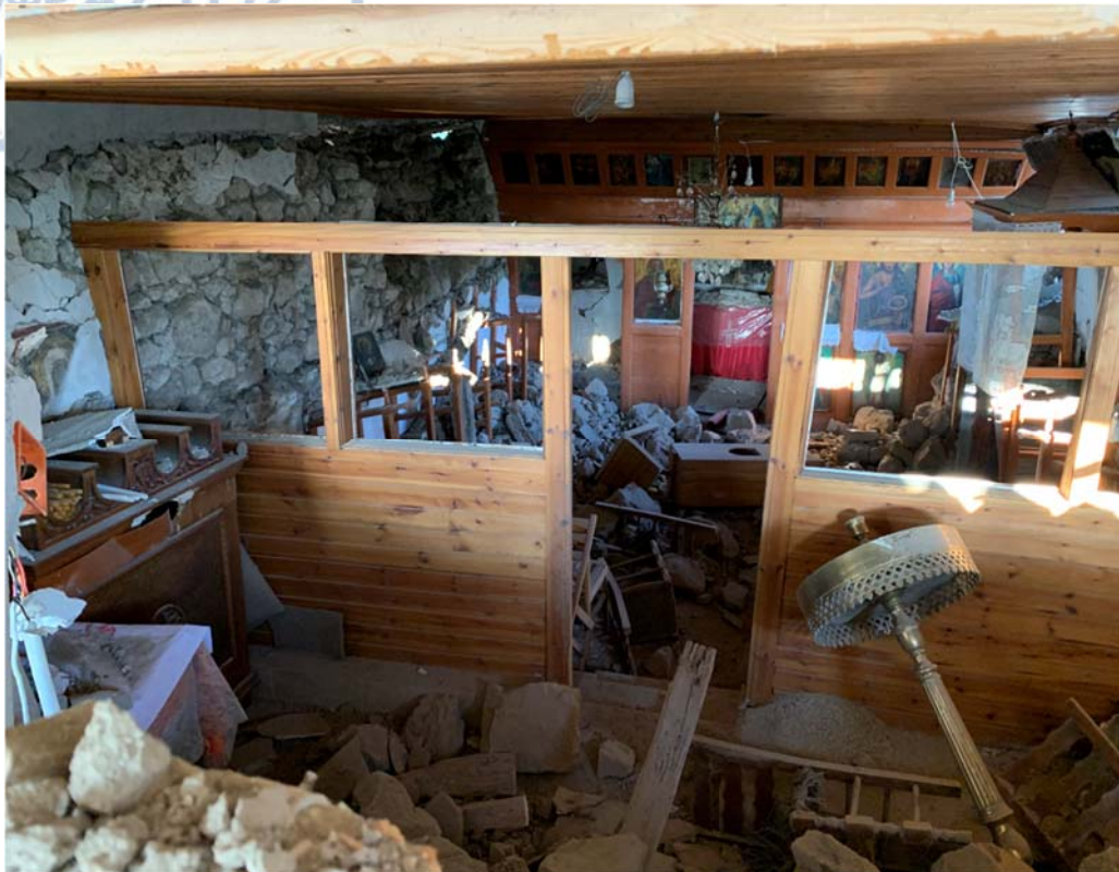
Σχήμα 2.5 : Πλήρης κατάρρευση του Ιερού Ναού Αγίου Δημητρίου (17 ου αιώνα) στο Κουτσόχερο Λάρισας.
