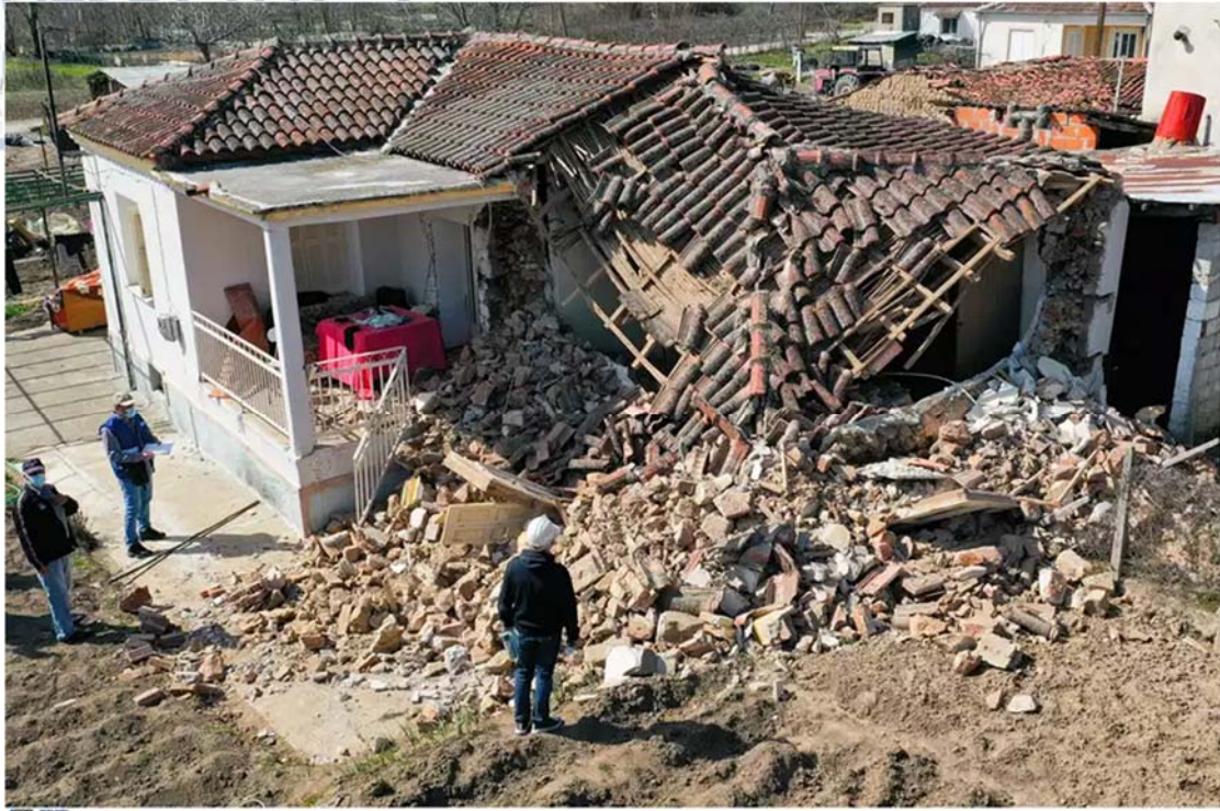
Σχήμα 2.2 : Κατάρρευση σκεπής σε σπίτι.
