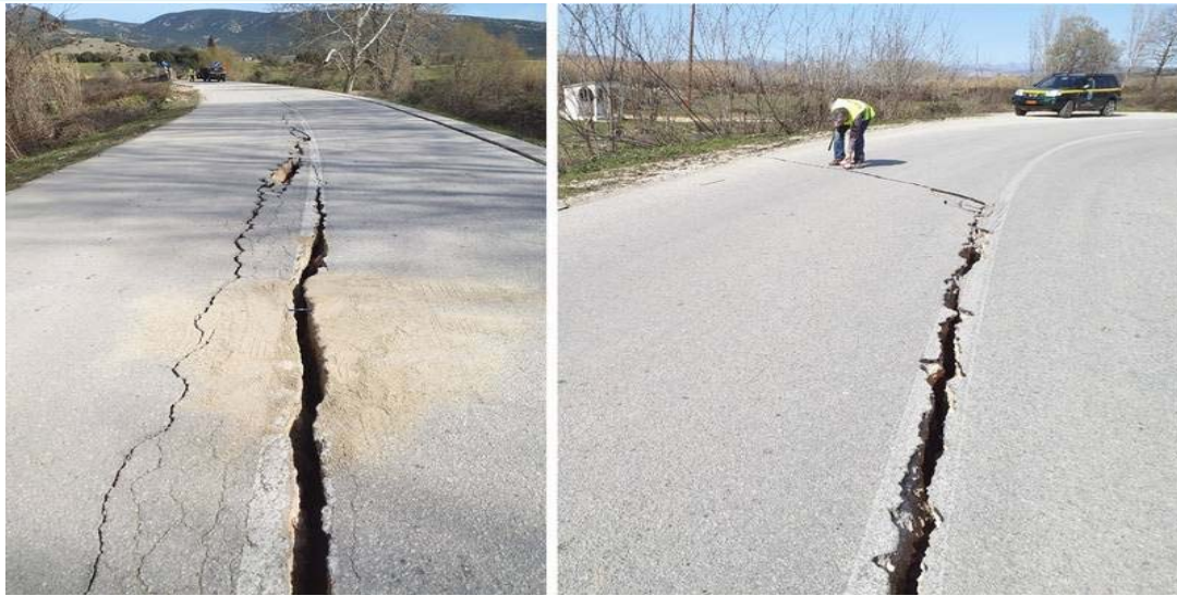
Σχήμα 2.8 : Γέφυρα Βλαχογιάννι, ρωγμές σε υλικά επιχωμάτων.
