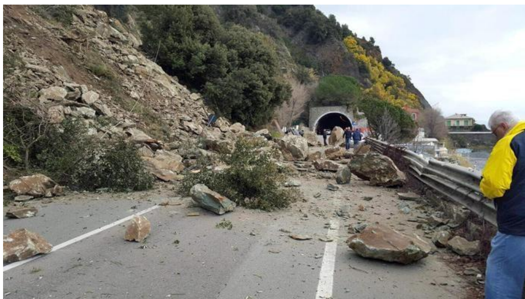
Εικόνα 14: Αστοχία πρανούς μετά το πέρας σήραγγας
