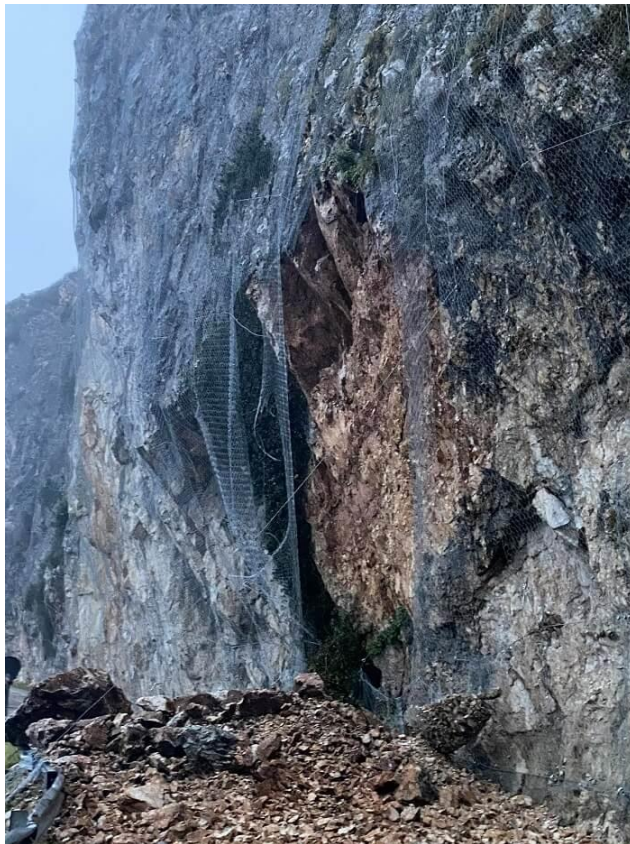
Εικόνα 12: Αστοχία μεταλλικού πλέγματος στον δρόμο Ιωαννίνων - Πράμαντα (2020)
