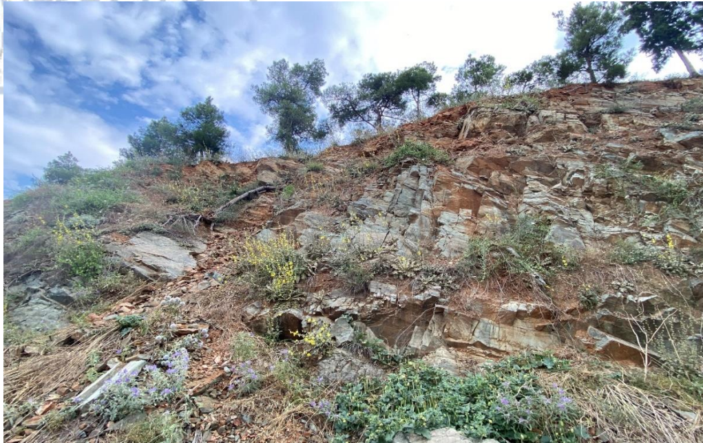
Εικόνα 19: Τμήμα του πρανούς μελέτης (1) – Ιούνιος 2023
