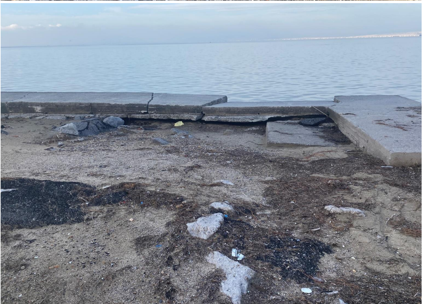
Εικόνα 26 Καθίζηση του υλικού πλήρωσης
