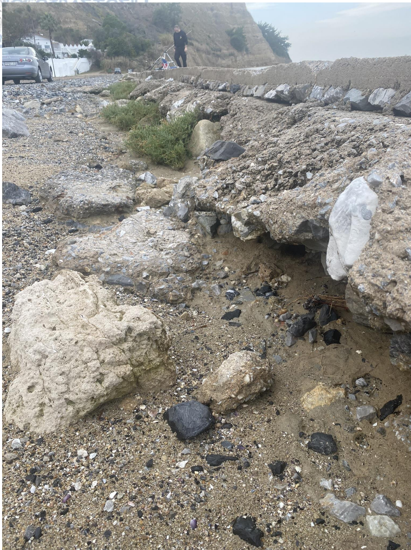
Εικόνα 28 Καθίζηση του υλικού πλήρωσης
