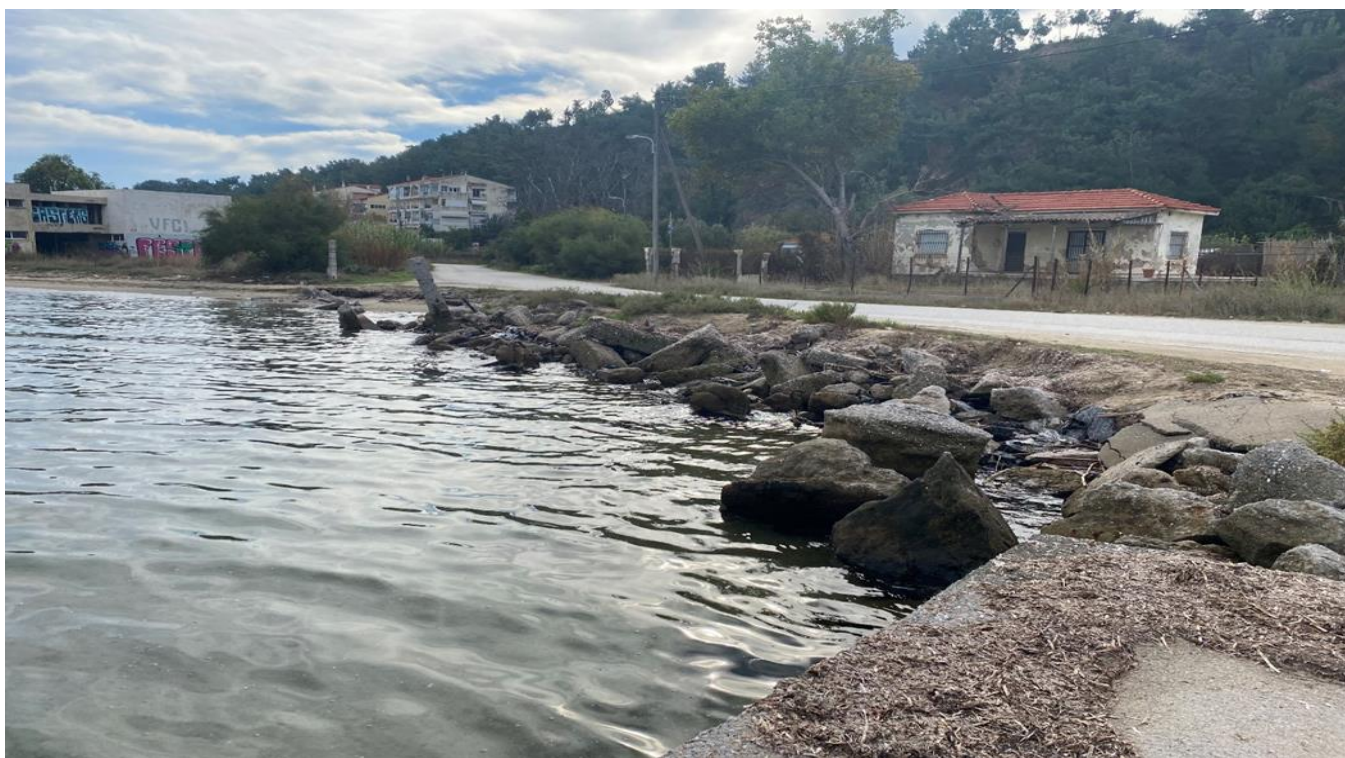
Εικόνα 48 Ο Μαντρότοιχος του ΠΙΚΠΑ και η ακτή σε έκταση πάνω από 25 μέτρα έχουν καταστραφεί. Νοε 2023
