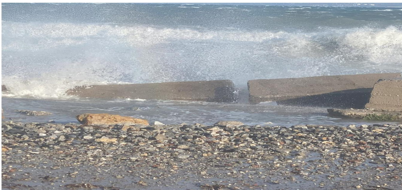
Εικόνα 34 Κατεστραμμένη στέψη του κρηπιδοτοιχου
