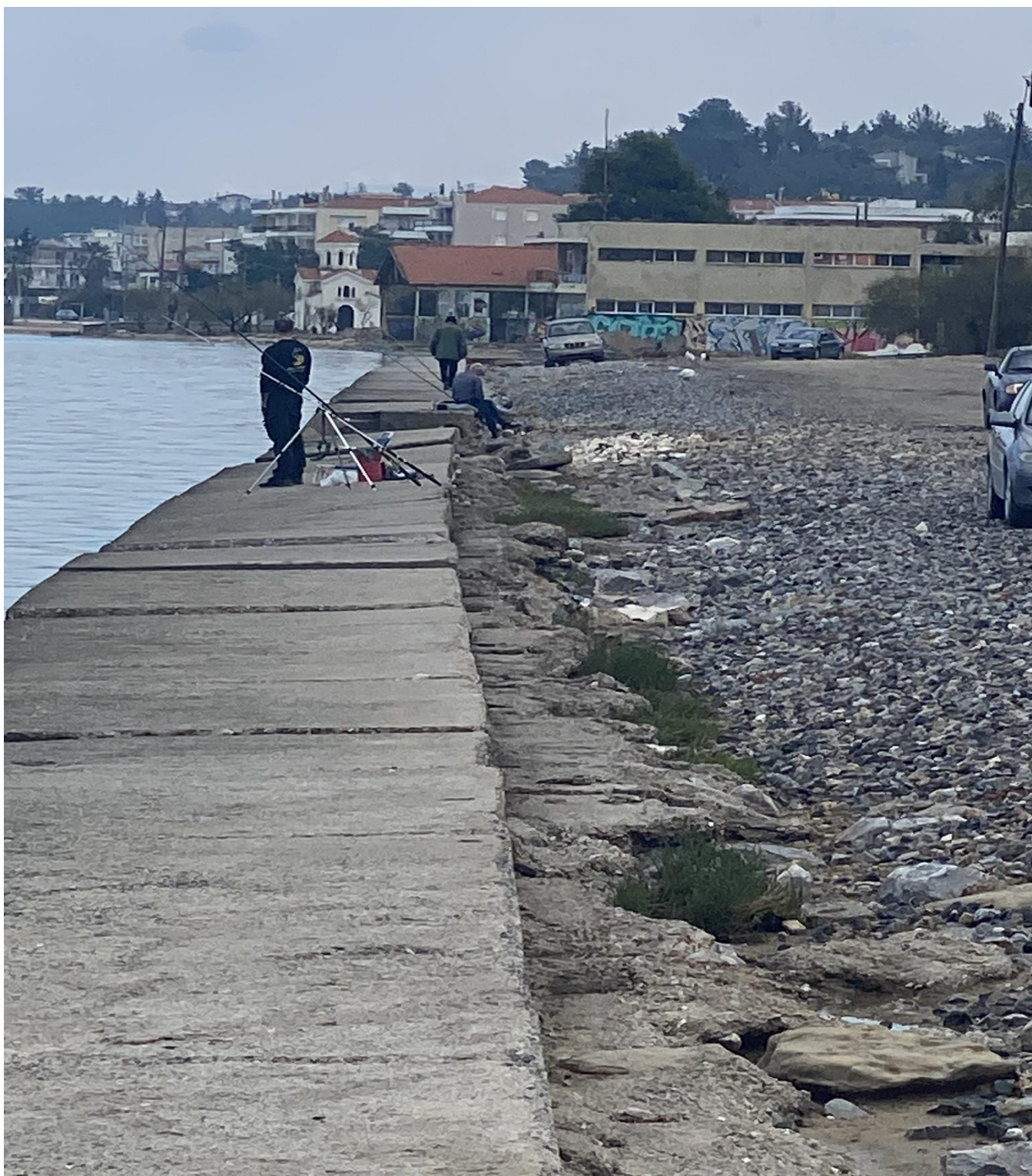
Εικόνα 24 Η Οριζόντια μετακίνηση της στέψης αλλά και η καθίζηση στο εσωτερικό είναι εμφανής.
