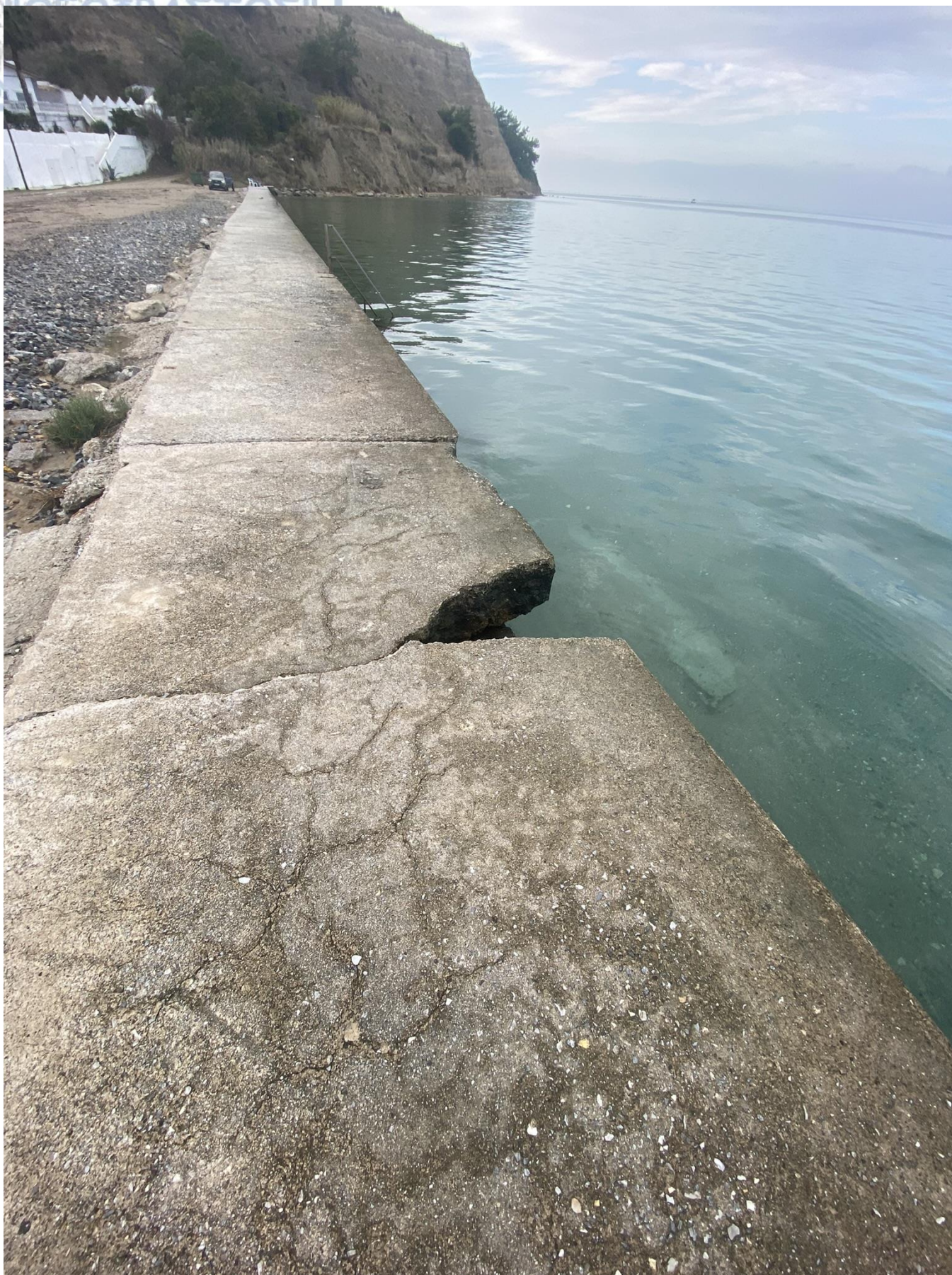
Εικόνα 38 Εμφανείς ρωγμές στην επιφάνεια στέψης
