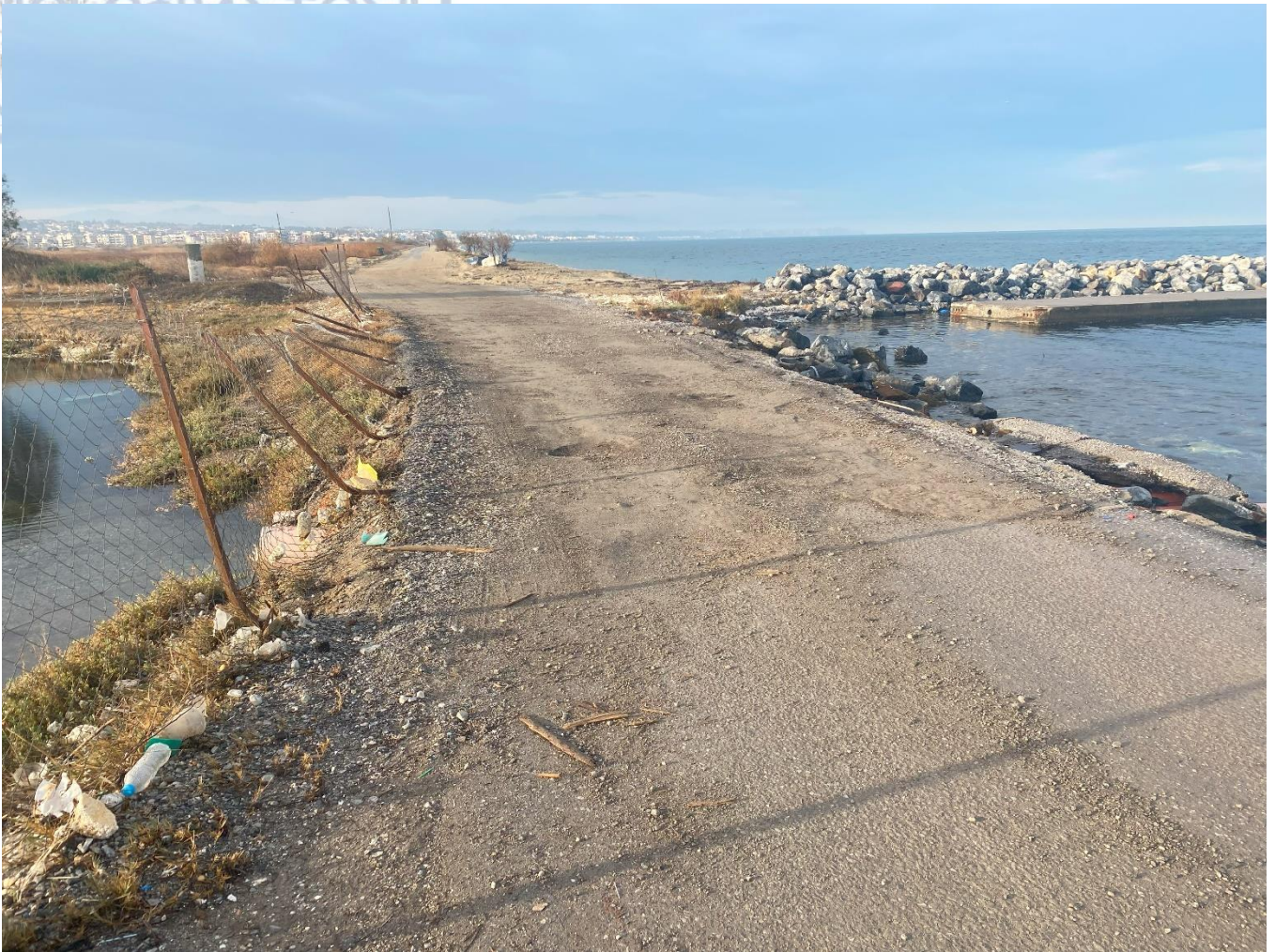
Εικόνα 84 Δρόμος της εισόδου του ΚΑΠΠΑ που φράζει την είσοδο στο λιμάνι του ΚΑΠΠΑ Δεκ 2023
