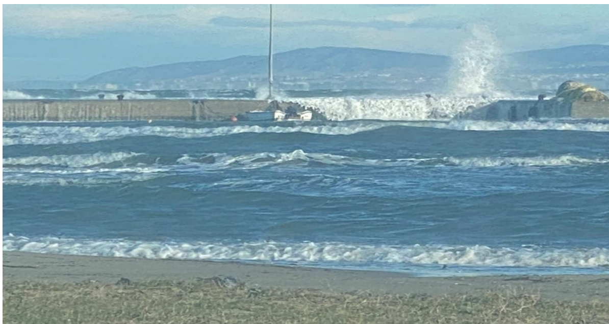
Εικόνα 16 Το κύμα έχει υπερπηδήσει και έχει πλημμυρίσει την κατασκευή. Νοε 2023
