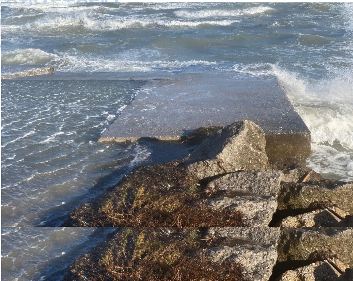
Εικόνα 17 Το κύμα έχει πλημμυρίσει τον κρηπιδοτοιχο. Νοε 2023
