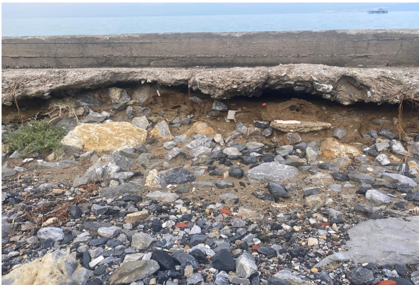
Εικόνα 25 Καθίζηση του υλικού πλήρωσης
