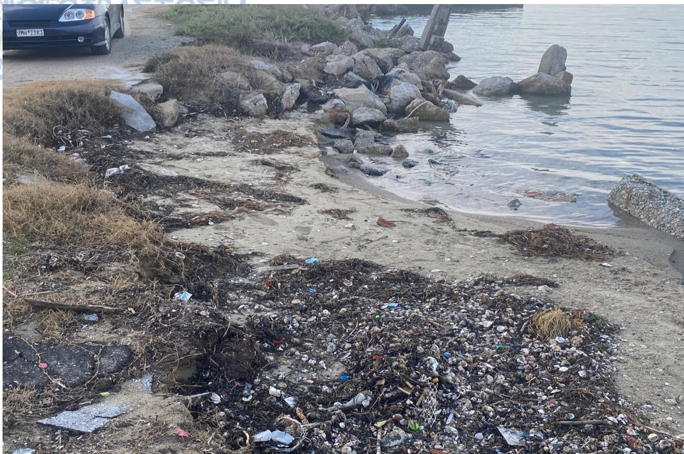
Εικόνα 47 Η τάση της διάβρωσης είναι να εισχωρήσει στον δρόμο. Νοε 2023
