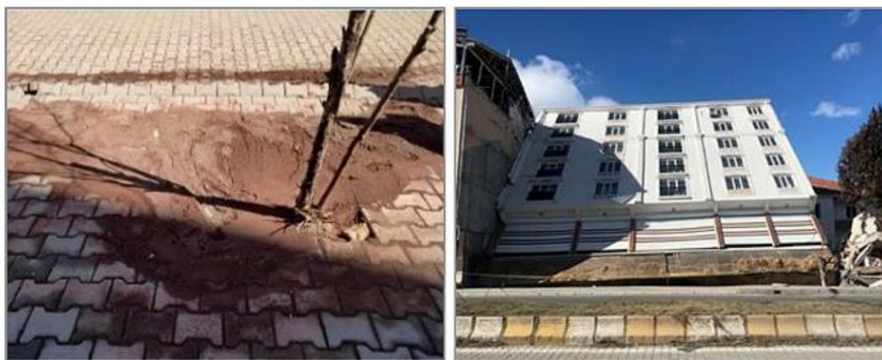
Εικόνα 12: Ανάδυση άμμου (αριστερά) και ανατροπή κτηρίου (δεξιά) στην περιοχή Gölbaşı του Adıyaman λόγω του φαινομένου της ρευστοποίησης (Demir et al., 2023).
