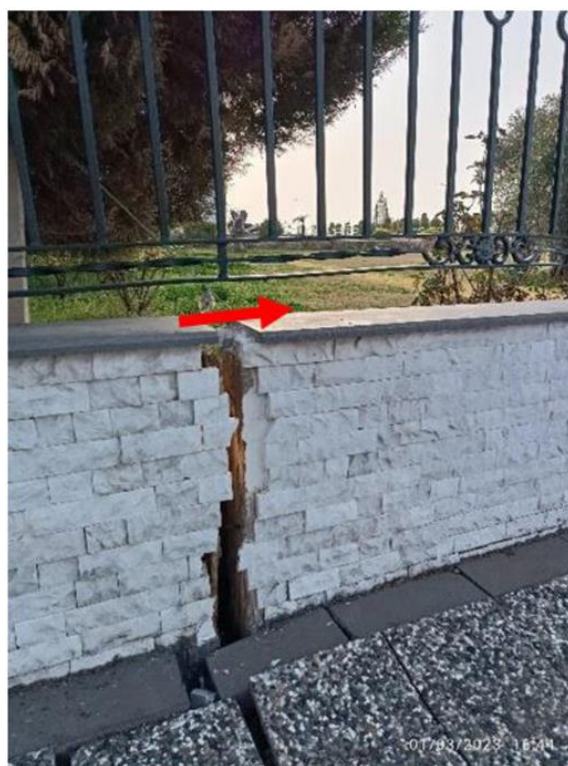
Εικόνα 7: Διαρρηγμένος τοίχος λόγω της πλευρικής εξάπλωσης στο Iskenderun [ 36^{\circ} 35' 36.00'' N; 36^{\circ} 9' 32.96'' E] (Φωτογραφία από M.M. Monkul, 2023).
