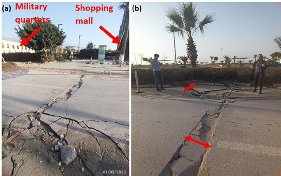
Εικόνα 8: α) Η κατάσταση της ασφάλτου και του πεζοδρομίου και οι ρωγμές που εμφανίζονται ανάμεσα στο εμπορικό κέντρο και στην στρατιωτική βάση στο Iskenderun , b) Πλευρικές παραμορφώσεις (περίπου 25 με 35 εκατοστά) της ασφάλτου σε διάφορες κατευθύνσεις [ 36^{\circ} 35' 36.29'' N ; 36^{\circ} 9' 36.82'' E ] (Φωτογραφίες από M.M. Monkul, 2023).
