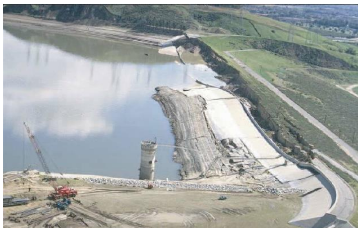
Εικόνα 4: Αστοχία του φράγματος San Fernando, 1971 (Jinto and Davidson, 2010)
