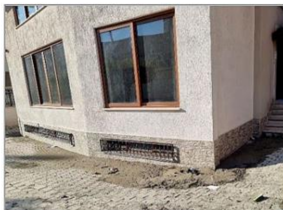
Εικόνα 9: Αναδύομενο αμμώδη υλικό γύρω από κατοικία στο Iskenderun (Demir et al., 2023).
