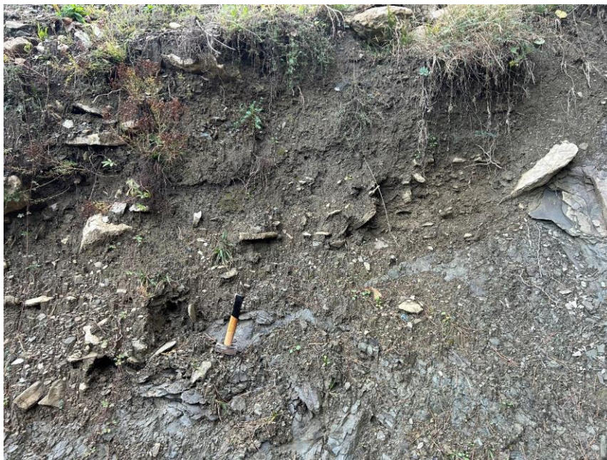
Σχήμα 12: Πλευρική παρατήρηση κατολίσθησης με εμφάνιση του μανδύα αποσάθρωσης
