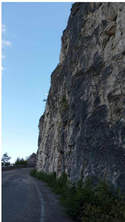
Εικόνα 24. Απόκρημνα στον δρόμο Ζιάκα-Σπήλαιο, Γρεβενά.
