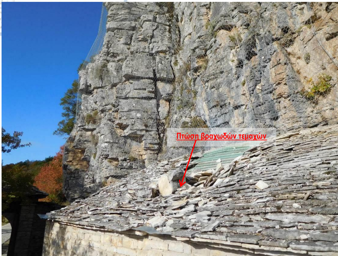
Εικόνα 9: Πτώση βράχων σε κτίσμα παραπλεύρως της καμαρωτής πύλης της Ι.Μ. Αγ. Παρασκευής, σε απόσταση πλέον των 120m από το μελετώμενο πρανές. Διακρίνεται η εφαρμογή πλέγματος στο ασβεστολιθικό πρανές.
