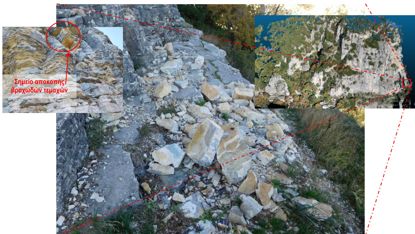
Εικόνα 34: Αστοχία στα βορειοανατολικά της περιοχής μελέτης, εντός του φαραγγιού του Βίκου και σε μικρή απόσταση περί τα 10-15m μετά την είσοδο σε αυτό. Τα πεσμένα βραχώδη τεμάχη αποκόπηκαν από ύψος 5m περίπου.
