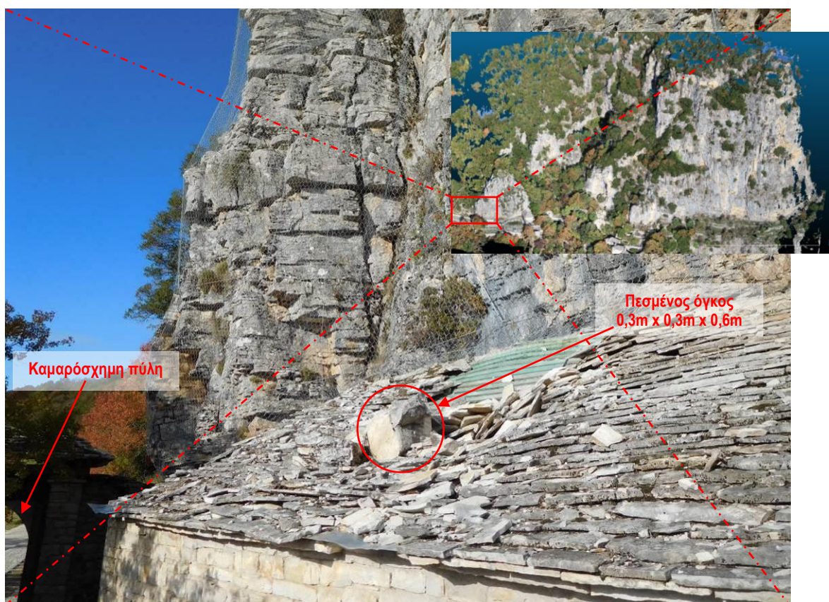
Εικόνα 31: Άποψη της αστοχίας πλησίον της καμαρόσχημης πύλης εισόδου στην Ι. Μ. Αγ. Παρασκευής (στα νοτιοδυτικά της ευρύτερης περιοχής μελέτης). Οι διαστάσεις του πεσμένου όγκου επί της σκεπής κτιρίου μετρήθηκε με τη βοήθεια του λογισμικού CloudCompare ίσες με 0,3\text{m} \times 0,3\text{m} \times 0,6\text{m} .
