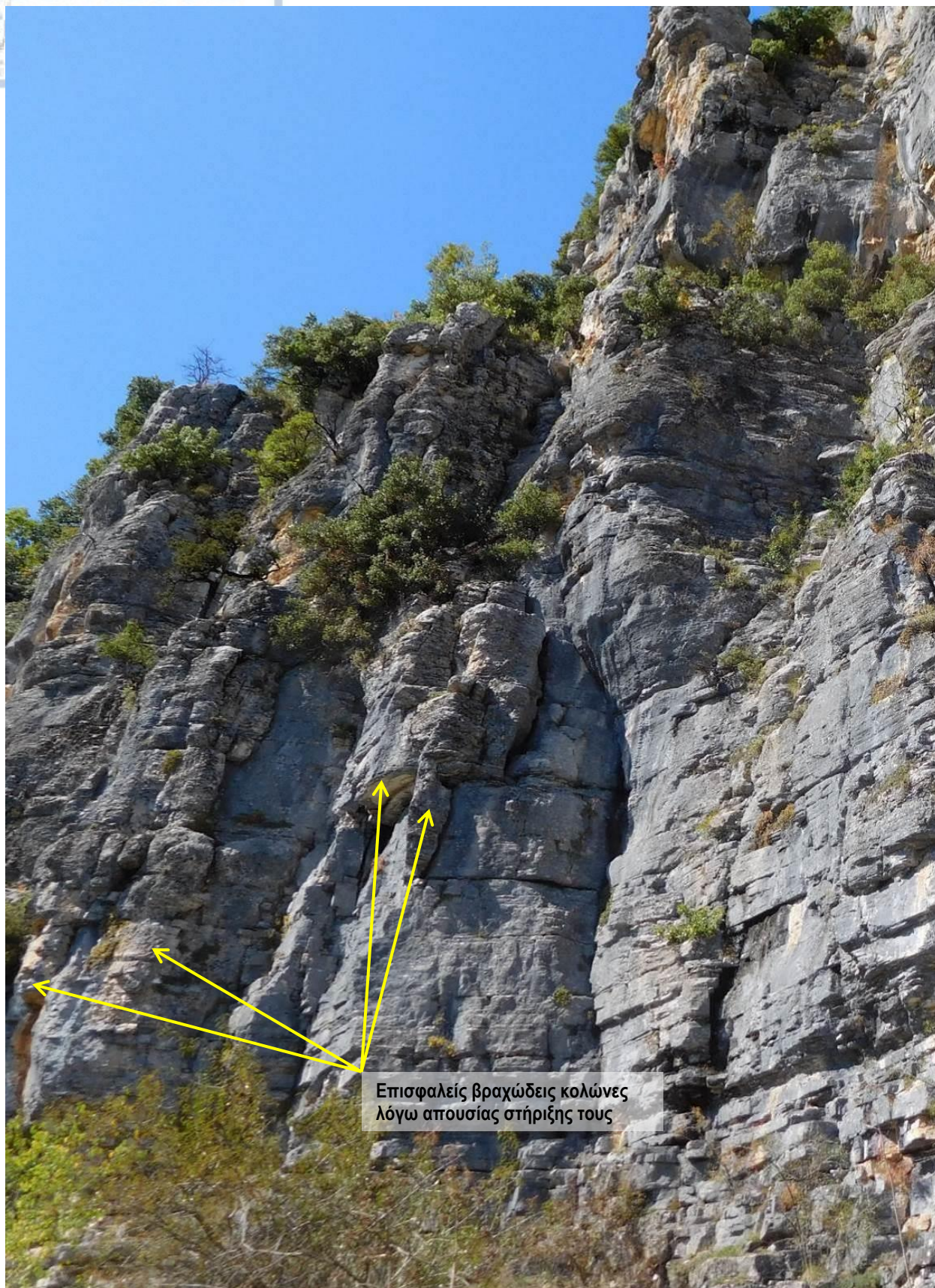
Εικόνα 21: Τμήμα του μελετώμενου ανθρακικού πρανούς. Διακρίνεται τοπικά η απουσία στήριξης βραχωδών στηλών (κολώνες) και η δημιουργία επικρεμάμενων (επισφαλών) βραχοτεμαχών.
