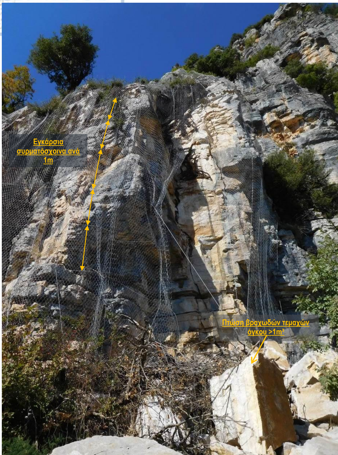
Εικόνα 14: Αστοχία πρανούς (Οκτώβριος 2021) και καταστροφή του πλέγματος και των εγκάρσιων συρματοσχοινών, στο δυτικό όριο του μελετώμενου πρανούς. Διακρίνονται πεσμένα βραχώδη τεμάχη μεγέθους >1\text{m}^3 .
