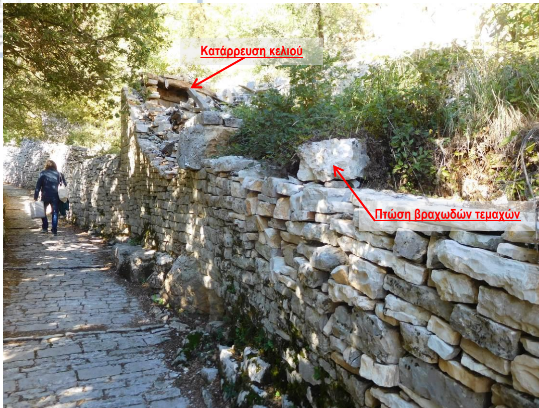
Εικόνα 11: Πλακόστρωτο μονοπάτι σύνδεσης της κεντρικής (καμαρόσχημης) πύλης με τα κυρίως κτήρια της Μονής, συμπεριλαμβανομένου του Ι.Ν. Αγίας Παρασκευής. Διακρίνονται το κατεστραμμένο τμήμα κελιού λόγω της αστοχίας του 2020 και πεσμένα βραχώδη τεμάχια.
