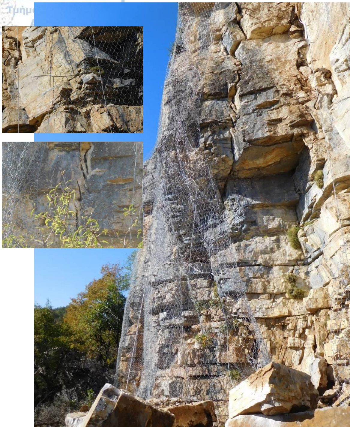
Εικόνα 24: Αστοχία του πρανούς σε άμεση γειτνίαση με τον Ι.Ν. Αγίας Παρασκευής. Διακρίνονται τα συρματόσχοινα που αστόχησαν και η ανάπτυξη αντίρροπων του πρανούς διακλάσεων που μελλοντικά δύναται να εξελιχθούν σε αστοχίες ανατροπών.
