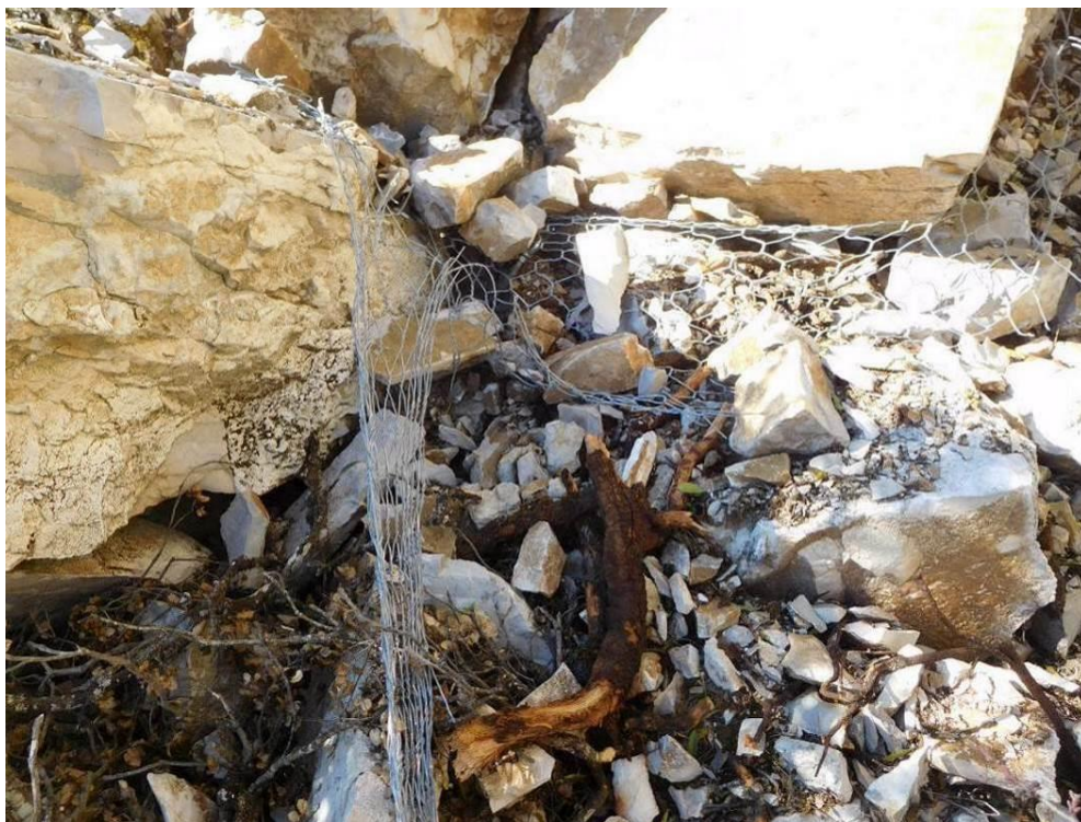
Εικόνα 12: Κατεστραμμένο πλέγμα στο δυτικό όριο του μελετώμενου πρανούς λόγω της αστοχίας του Οκτωβρίου 2021.
