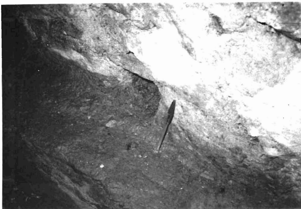
Φωτ. 4. Στραγγιστήριο στη βάση της σήραγγας Δ (βλ. Σχ. 2). Το παραπάνω στραγγιστήριο έχει αδρανοποιηθεί εξαιτίας της αποθέσεως κλαστικών και χημικών ιζημάτων \text{CaCO}_3 .
