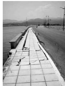
Σχήμα 5γ. Λευκάδα- Δίαυλος: Καθίζηση επιχώματος.
