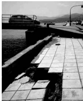
Σχήμα 5β. Λευκάδα – είσοδος: Αστοχία κρηπιδώματος στην πλωτή γέφυρα
