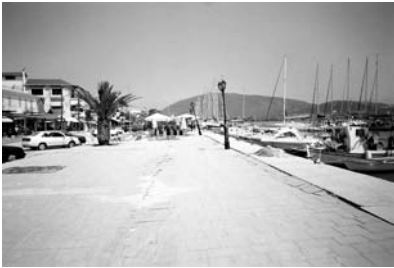
Σχήμα 5α. Λευκάδα-Οδ. Γκολέμη: Καθίζηση υλικού επίχωσης
