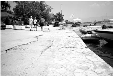
Σχήμα 6α. Νυδρί: Ρωγμές πίσω από τον κρηπιδότοιχο
