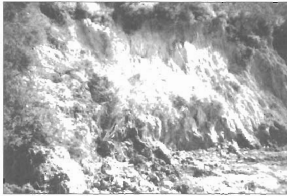
Φωτ. 1. Αστοχία στο τεχνητό πρανές του δρόμου (1 η θέση). Photo 1. Failure at the artificial slope of the road (1 st place).
