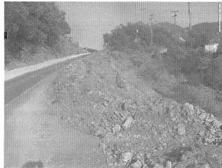
Φωτογραφία 4: Καταστροφές στο οδικό δίκτυο σε σχηματισμούς φλύσχη στο Ματονερί
