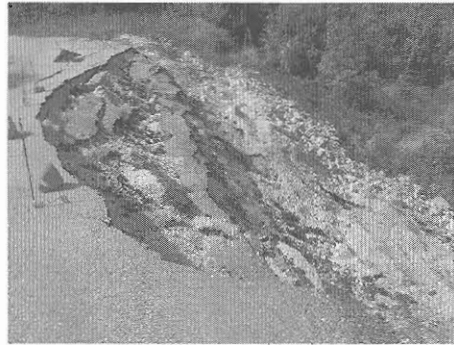
Φωτογραφία 3: Καθιζήσεις δρόμων σε σχηματισμούς κερατολίθων στην επαρχιακή οδό Τρικάλων – Άρτας
