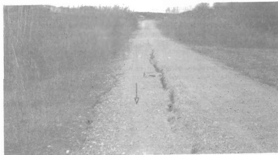
Εικ. 2. Εδαφικές διαρρήξεις διεύθυνσης ΝΝΑ-ΒΒΔ κατά μήκος του αγροτικού δρόμου Βαρθολομίου-Μπούκας. Οι διαρρήξεις έχουν άλμα της τάξης των 5-10 εκατοστών με αποτέλεσμα το ενδιάμεσο μικρο-τέμαχος να έχει ταπεινωθεί σε σχέση με τα εκατέρωθεν ευρισκόμενα.
