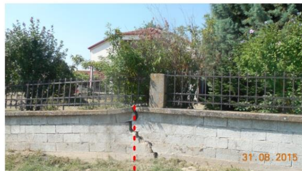
Εικόνα 1-2: Ρωγμές που παρατηρήθηκαν στην περιοχή των Βαλτονέρων. Στα σημεία αυτά ελήφθησαν και οι μετρήσεις τόσο της ηλεκτρικής τομογραφίας όσο και των σεισμικών.
