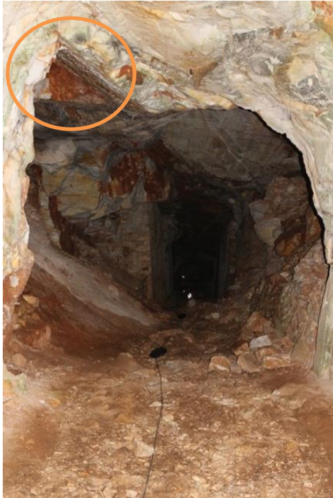
Εικόνα 37. Κατά μήκος της στοάς 1 διαπιστώθηκαν μικρού όγκου σφηνοειδείς καταπτώσεις (σφήνα 8) στην αριστερή πλευρά της οροφής της στοάς.
