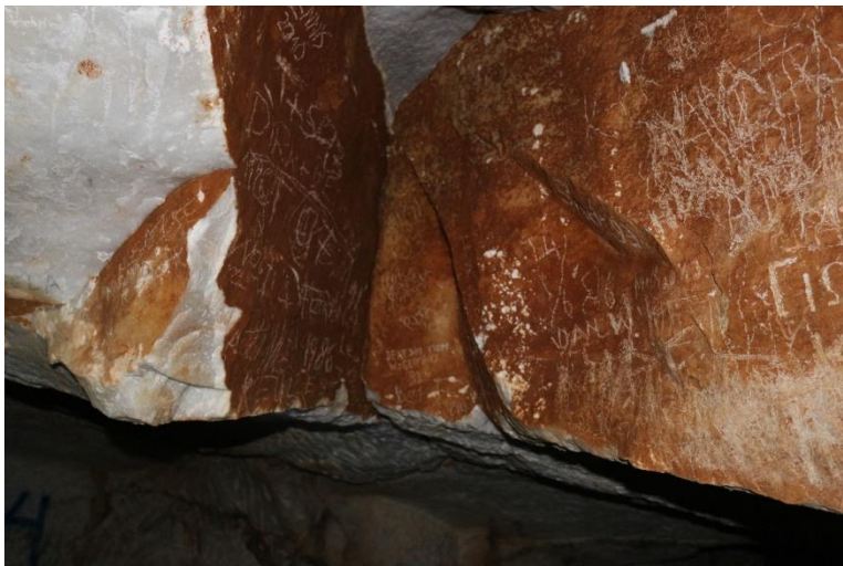
Εικόνα 40. Μικρού όγκου σφήνα στην οροφή της στοάς προς το τέλος της στην είσοδο δευτερεύουσας εγκάρσιας στοάς.
