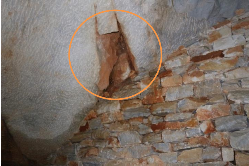
Εικόνα 39. Μικρού όγκου σφηνοειδείς καταπτώσεις (σφήνα 7) στη δεξιά πλευρά της οροφής της στοάς.
