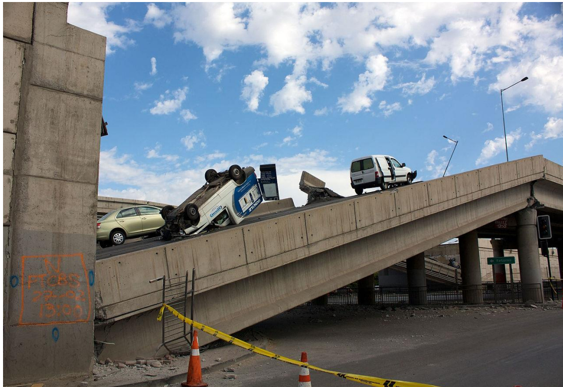
Σχήμα 2.3.2. Κατεστραμμένο τμήμα αυτοκινητόδρομου μετά τον φονικό σεισμό, Σαντιάγο. πηγή: www.Flickr.com
