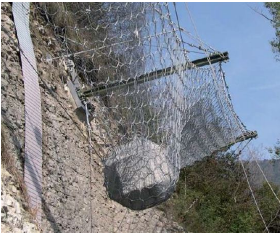
Εικόνα 1.8 Φράκτης αναχαίτισης στον οποίο έχει πέσει ογκώδες δοκιμαστικό βραχοτεμάχιο
