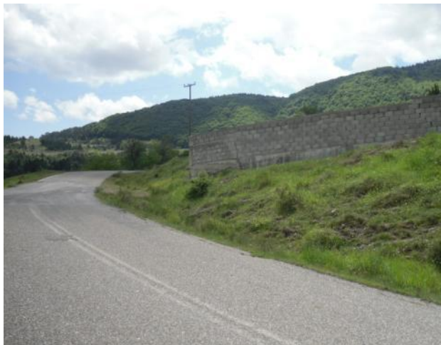
5.13 Ρωγμές στον τοίχο του κτίσματος, θέση 9
