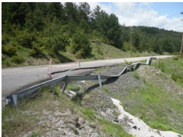
Εικόνα 5.7 Η αστοχία του επιχώματος, θέση 6
