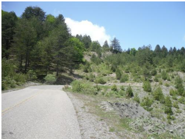
Εικόνα 5.11 Η κύρια κατακρήμνιση ανάντη του επιχώματος, θέση 8
