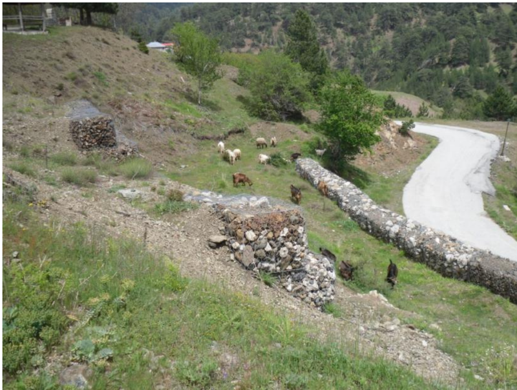
Εικόνα 5.21 Συρματοκιβώτια για την ανάσχεση της μετακίνησης, θέση 16
