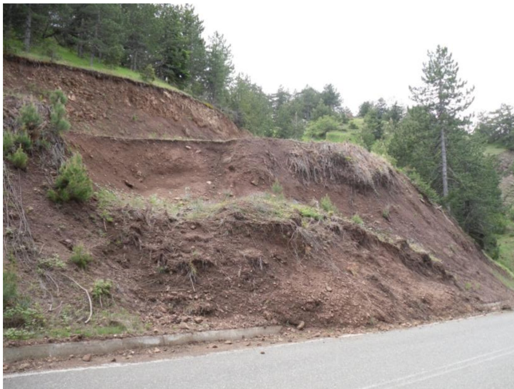
Εικόνα 5.17 Περιστροφική ολίσθηση στο πρανές, θέση 12
