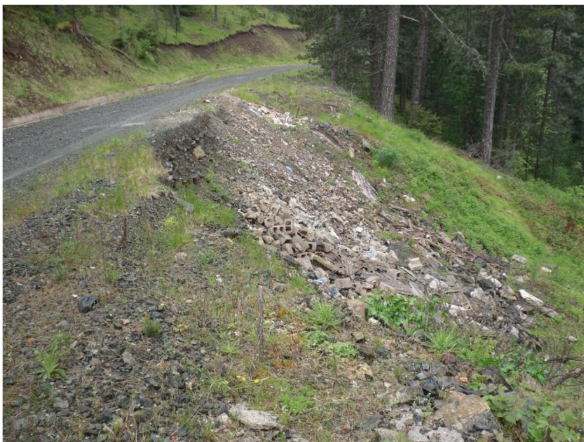
Εικόνα 5.22 Αστοχία στο επίχωμα, θέση 17
