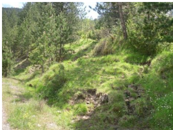
Εικόνα 5.8 Η αστοχία του πρανούς, θέση 6
