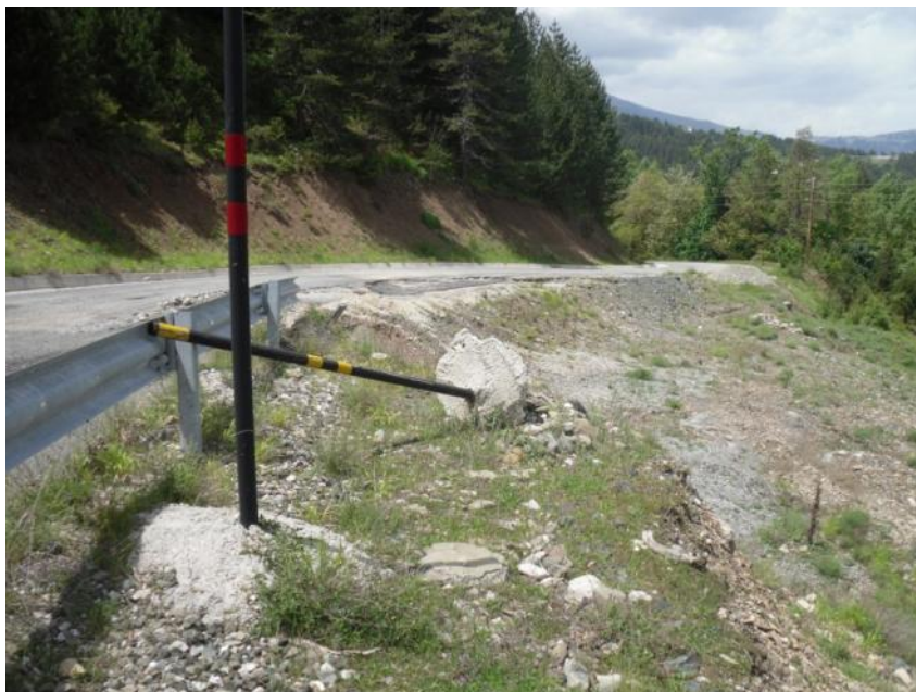
Εικόνα 5.15 Κατακρήμνιση στο επίχωμα, θέση 10
