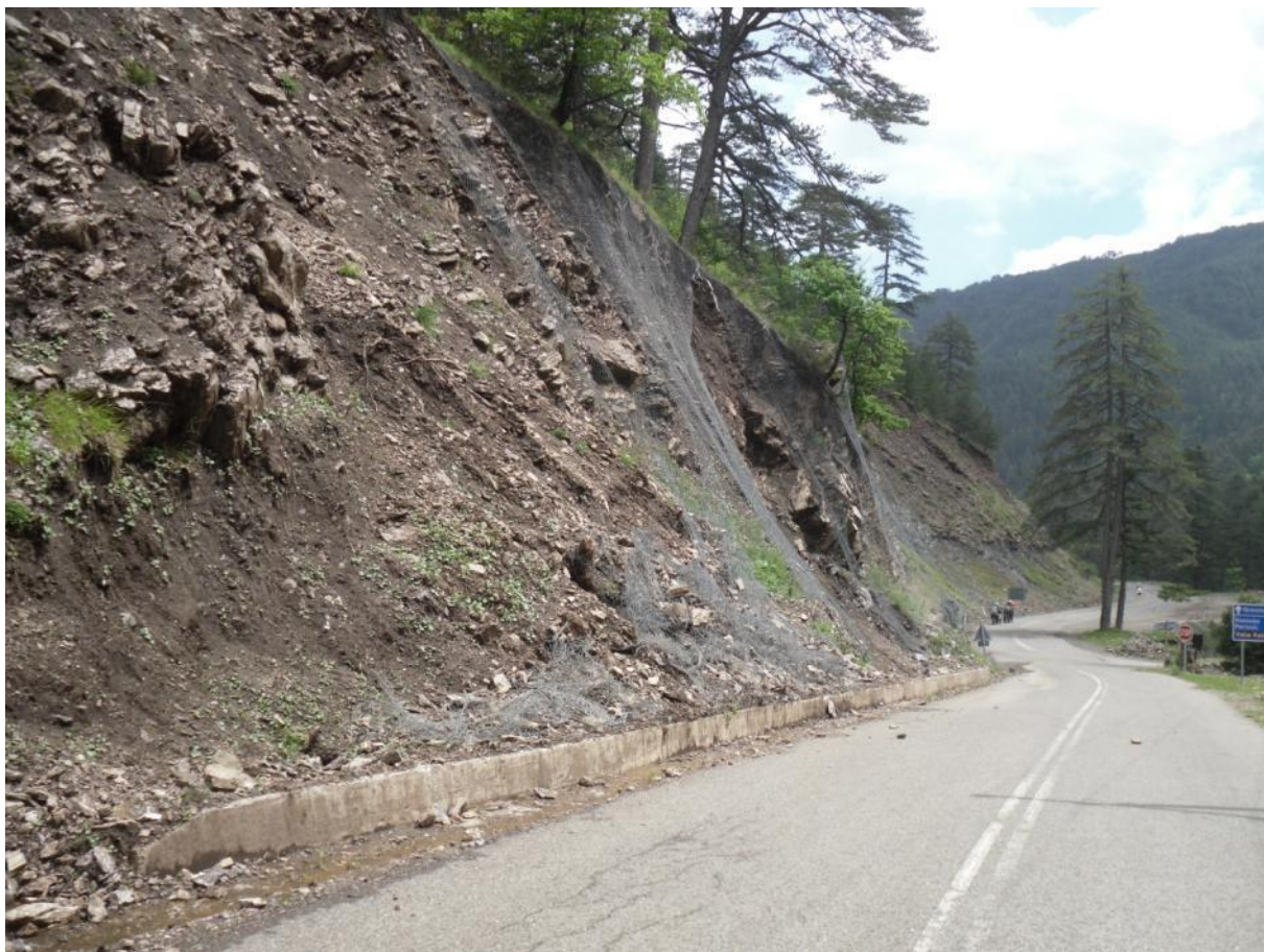
Εικόνα 5.19 Αστοχία στο πλέγμα συγκράτησης, θέση 14
