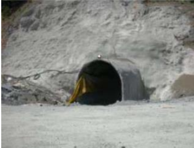
Εικόνα 37 : Στόμιο εισόδου σήραγγας αποστράγγισης
