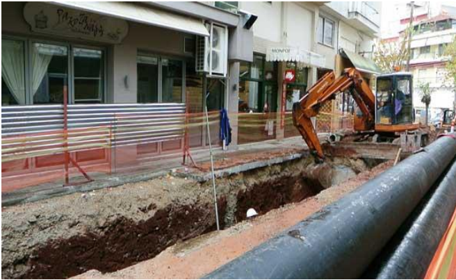
Εικόνα 27 : Υπόγειος αγωγός τηλεθέρμανσης (Κοζάνη)
