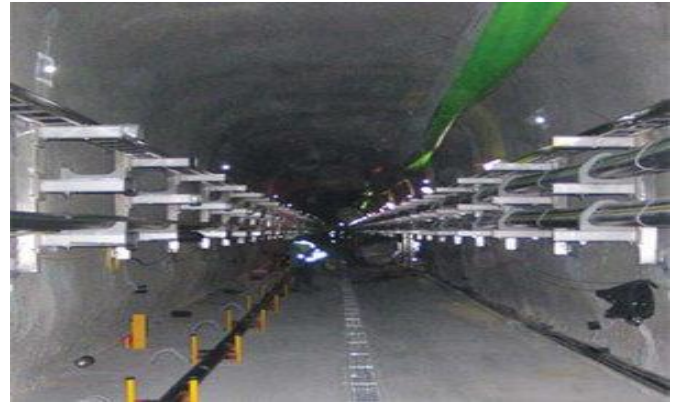
Εικόνα 28 : Ηλεκτρικά καλώδια και καλώδια επικοινωνίας
