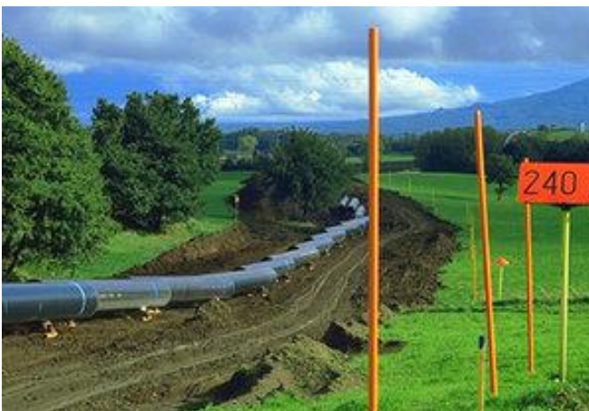
Εικόνα 30 : Αγωγός μεταφοράς ενέργειας
