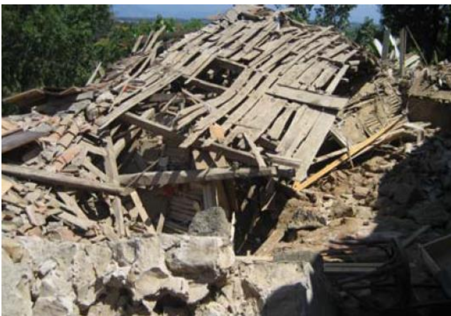
Σχήμα 2.3.2.1 Οικισμός Φώσταινα: Μερική κατάρρευση λιθοδομής με αργιλοκονίαμα (επάνω), Ολική κατάρρευση κτιρίου από λιθοδομή (κάτω). (πηγή: http://www.itsak.gr/uploads/news/earthquake_reports/AchaiaIlia/Achaia-Ilia_Jun2008_4thReport.pdf )
