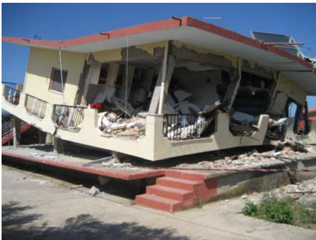
Σχήμα.2.3.2.3 Οικισμός Διδαχαίικα. Κατάρρευση διώροφης οικοδομής από Ο/Σ με μαλακό ισόγειο όροφο.
