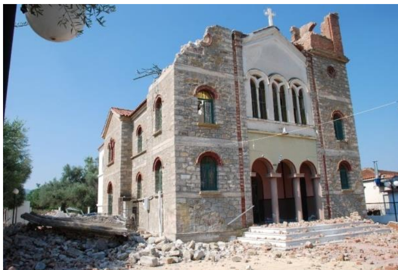
Σχήμα 2.3.3.1 βλάβες σε λιθόκτιστο ναό
