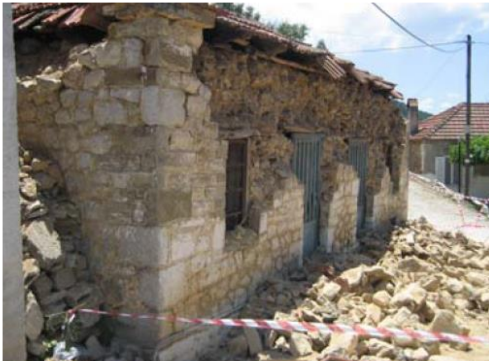
Σχήμα 2.3.2.2 Οικισμός Σαντομέρι: Μερική κατάρρευση κτιρίου από πτώση βράχου (επάνω), ) Μερική κατάρρευση λιθοδομών (κάτω).
