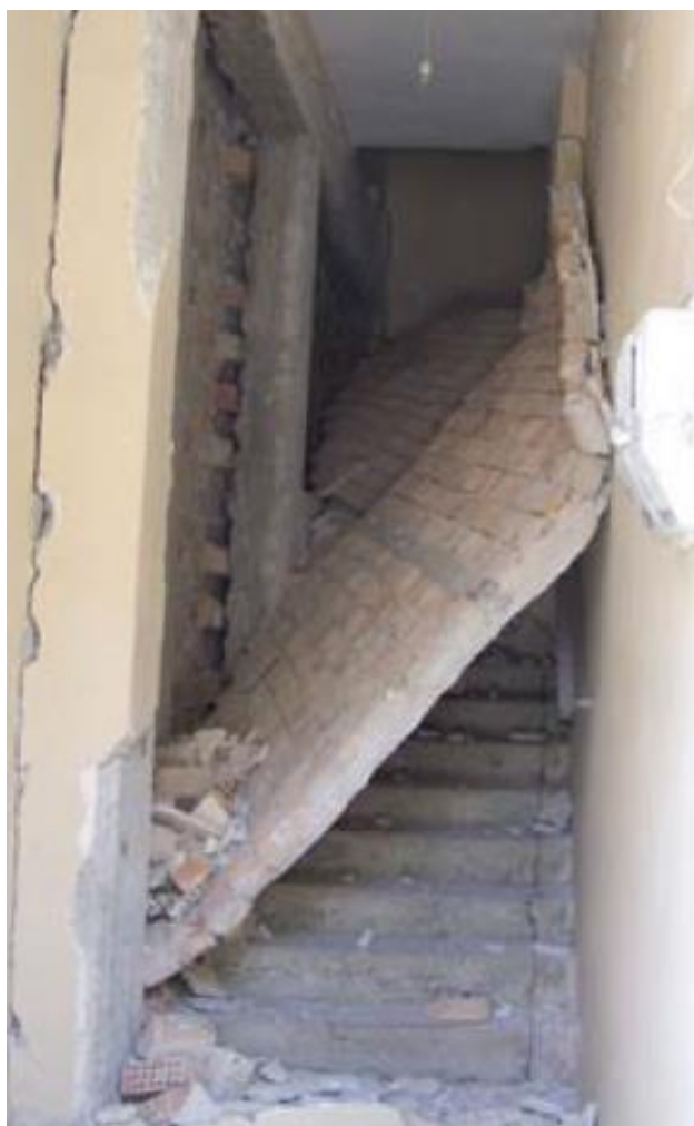
Σχήμα 2.3.2.5 Βαρθολομιό, Μερική κατάρρευση τοιχοποιιών πλήρωσης .
