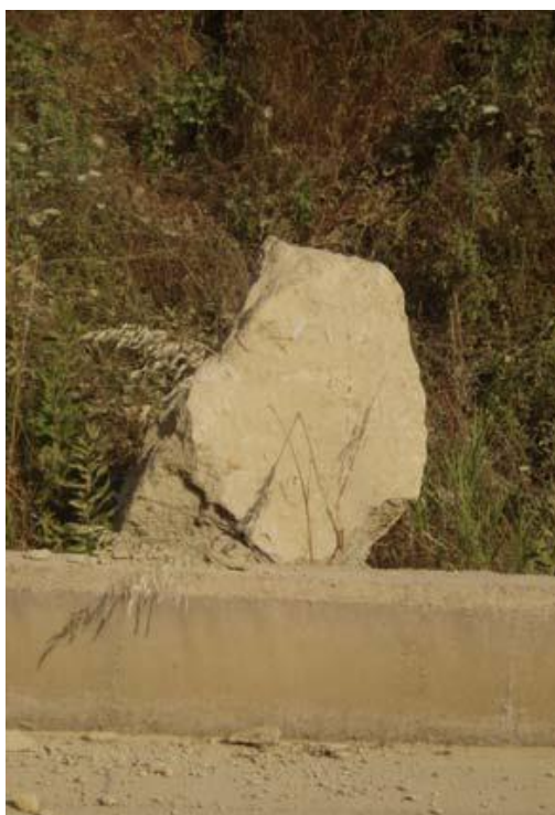
Σχήμα 2.4.1.2 Αποκόλληση βράχου κατά μήκος του δρόμου Πόρτες- Βάλμη. (πηγή: http://www.itsak.gr/uploads/news/earthquake_reports/AchaiaIlia/Achaia-Ilia_Jun2008_4thReport.pdf )
