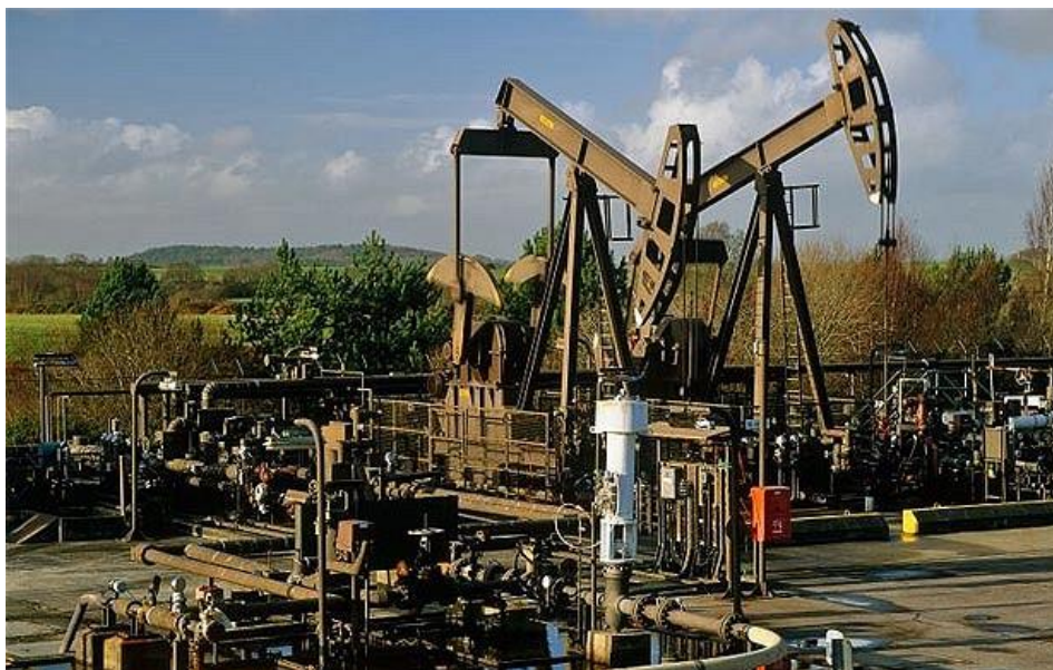
Εικόνα 42: Χερσαίες εγκαταστάσεις στην βιομηχανία των υδρογονανθράκων. (69)
