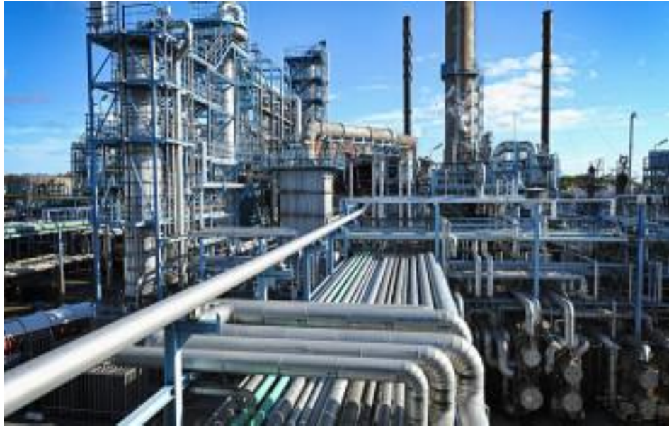
Εικόνα 41: Χερσαίες εγκαταστάσεις στην βιομηχανία των υδρογονανθράκων. (68)
