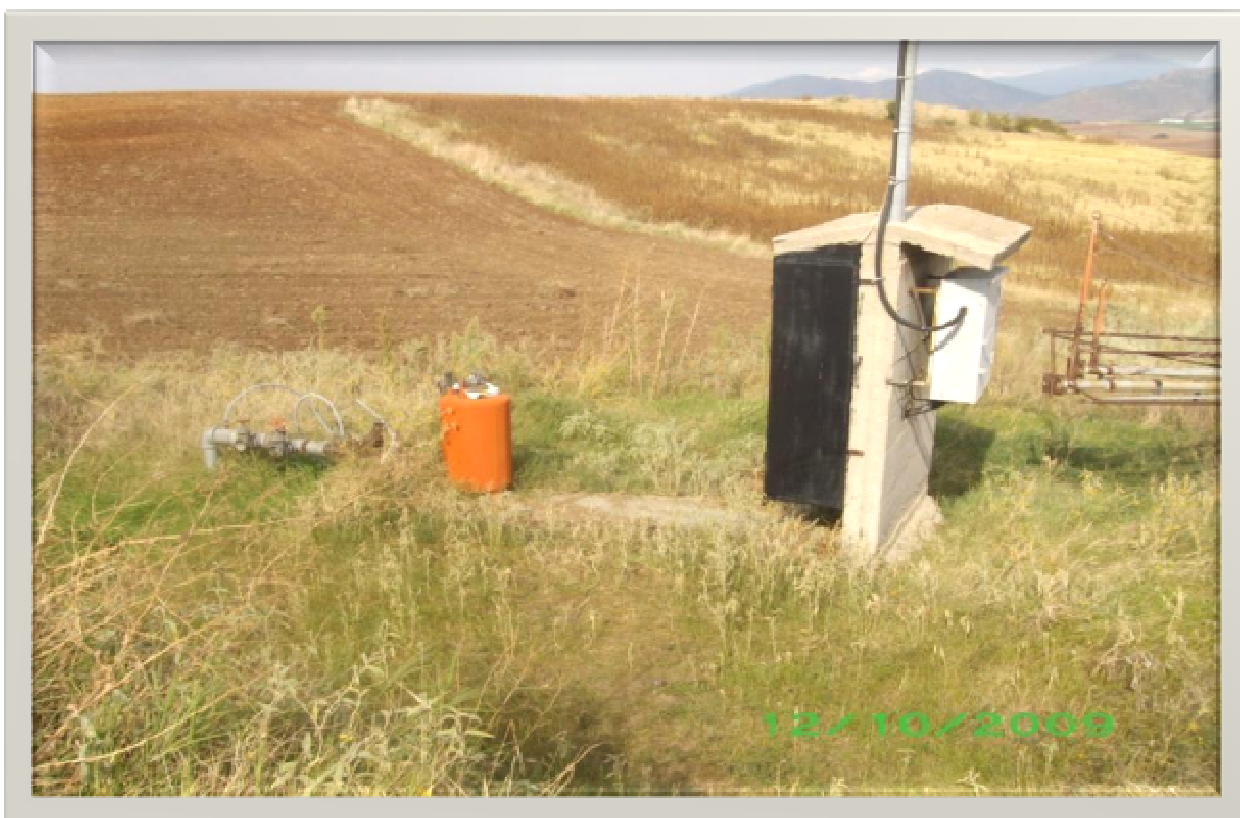
Σχήμα Γεώτρηση της περιοχής του Άνω Ανθεμούντα για αρδευτικούς σκοπούς.
