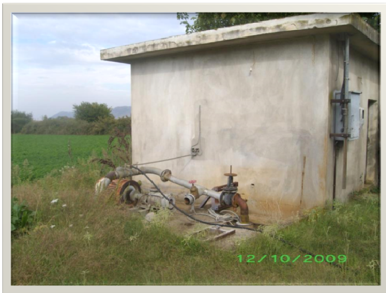
Σχήμα Γεώτρηση της περιοχής του Άνω Ανθεμούντα για αρδευτικούς σκοπούς.
