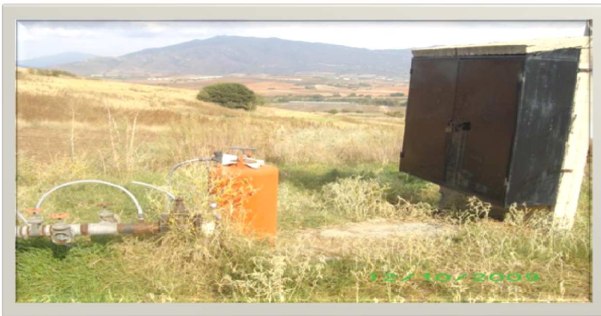
Σχήμα Γεώτρηση της περιοχής του Άνω Ανθεμούντα για αρδευτικούς σκοπούς.
