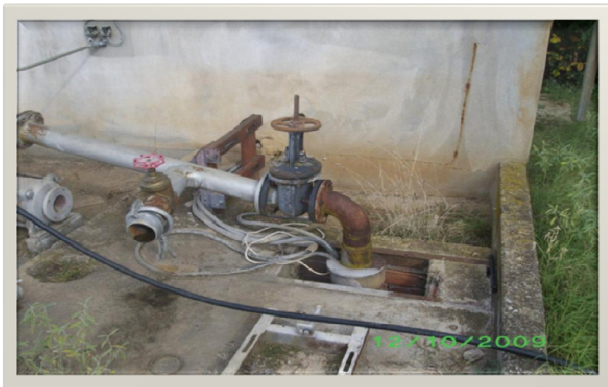
Σχήμα Γεώτρηση της περιοχής του Άνω Ανθεμούντα για αρδευτικούς σκοπούς.
