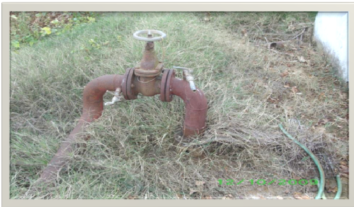
Σχήμα Γεώτρηση της περιοχής του Άνω Ανθεμούντα για αρδευτικούς σκοπούς.
