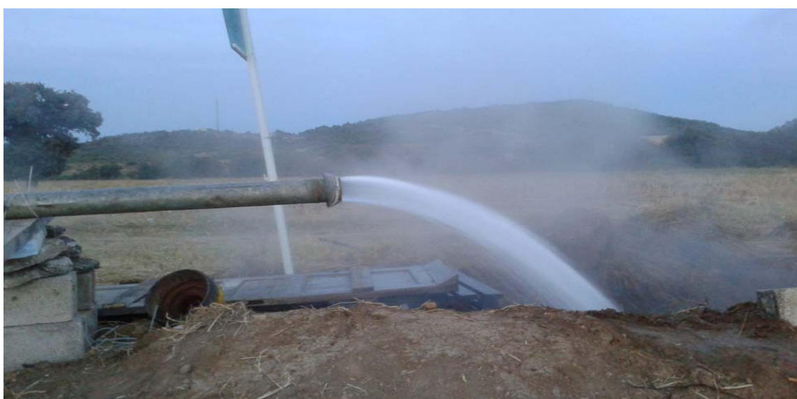
Εικόνες 2, 3: Αντλητικό συγκρότημα κατακόρυφου άξονα τύπου «πομόνας» σε πλήρη διαδικασία άντλησης. Κινητήρας 160 HP με βάθος τοποθέτησης 48 m.
