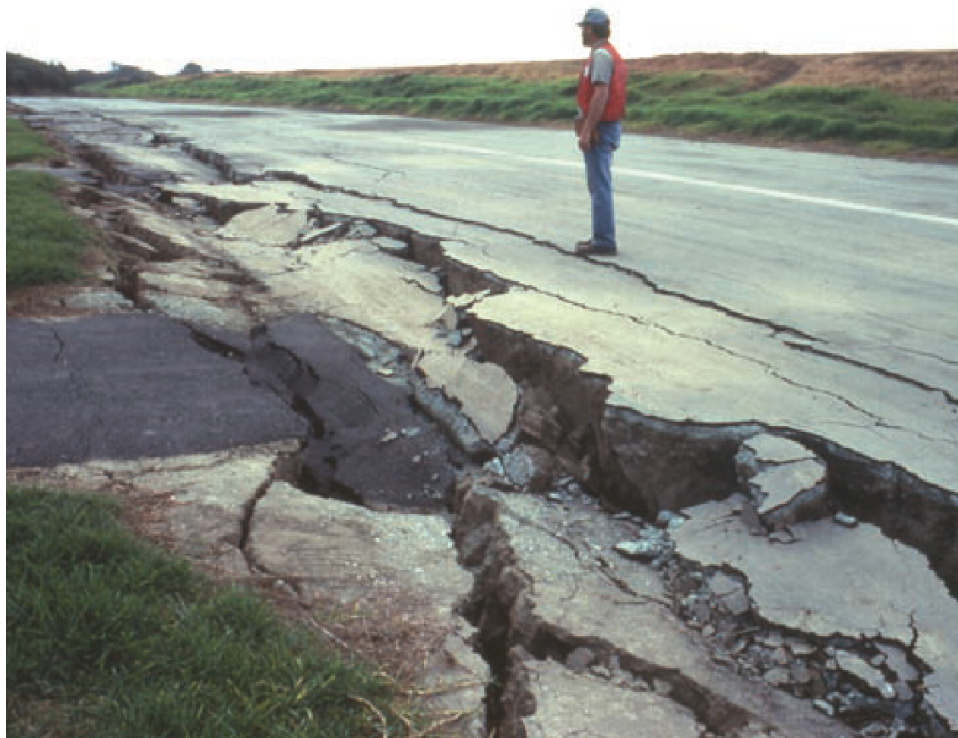
Εικόνα 1.9: Φωτογραφία πλευρικής εξάπλωσης σε οδόστρωμα, ως αποτέλεσμα, του σεισμού 1989 LomaPrieta, Καλιφόρνια, ΗΠΑ. (Highland & Bobrowsky, 2008)
