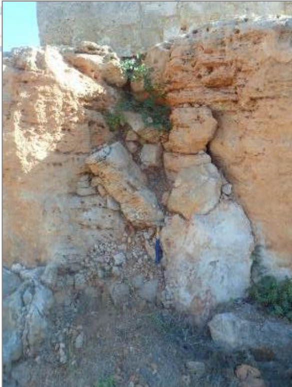
ΕΙΚΟΝΑ 3.40: Αστοχία στην Δυτική πλευρά εξωτερικά του Τάφου 4
