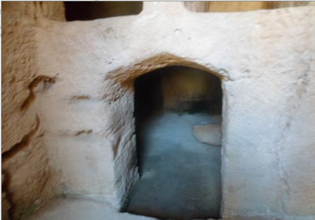
ΕΙΚΟΝΑ 3.34 : Εμφάνιση πράσινο χρώματος στην επιφάνεια του πετρώματος λόγω στάσιμου νερό μετά την χειμερινή περίοδο με πολλές βροχοπτώσεις στον θάλαμο Τάφου 4
