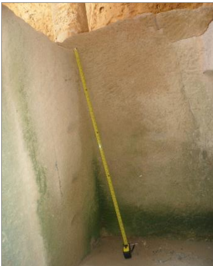
ΕΙΚΟΝΑ 3.35 : Εμφάνιση πράσινο χρώματος στην επιφάνεια του πετρώματος λόγω στάσιμου νερό μετά την χειμερινή περίοδο με πολλές βροχοπτώσεις στον θάλαμο Τάφου 4
