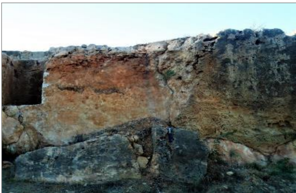
ΕΙΚΟΝΑ 3.39: Αποκόλληση τεμάχους στην Νότια πλευρά εξωτερικά Τάφου 3
