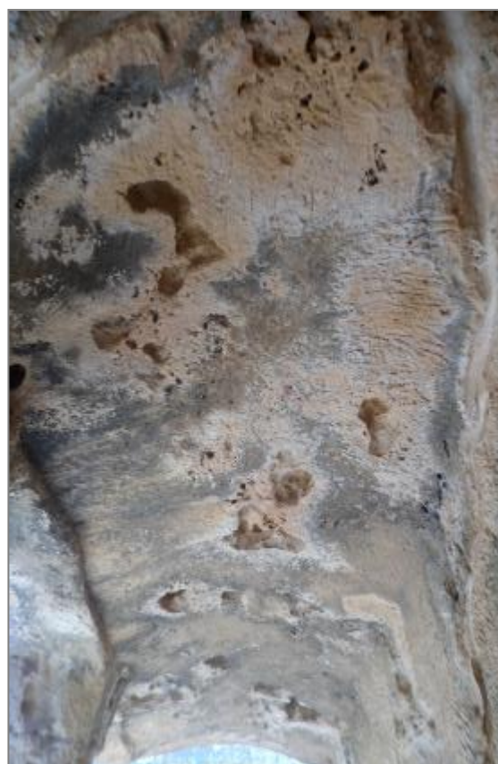
ΕΙΚΟΝΑ 3.32: Αποχρωματισμός πετρώματος στον αίθριο χώρο του Τάφου 4, πιο κοντινή άποψη
