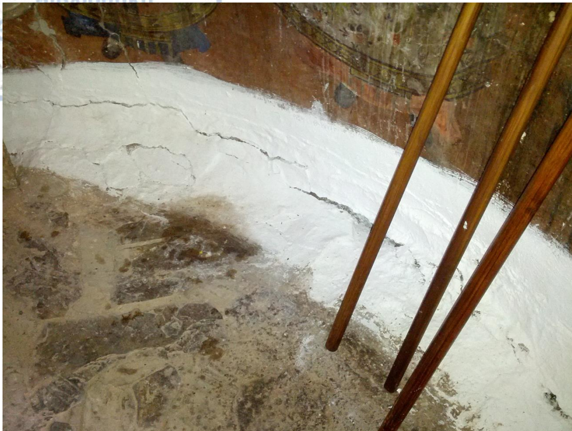
Εικόνα 7: Άποψη του εσωτερικού του ναού με τις ρωγμές που δημιουργήθηκαν από τα ερπυστικά φαινόμενα
