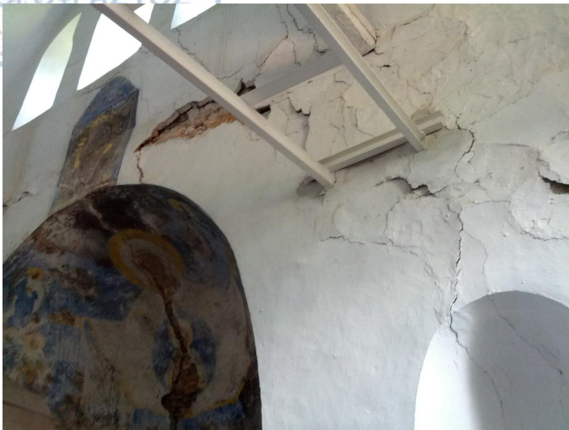
Εικόνα 6: Άποψη του εσωτερικού του ναού με τις ρωγμές που δημιουργήθηκαν από τα ερπυστικά φαινόμενα
