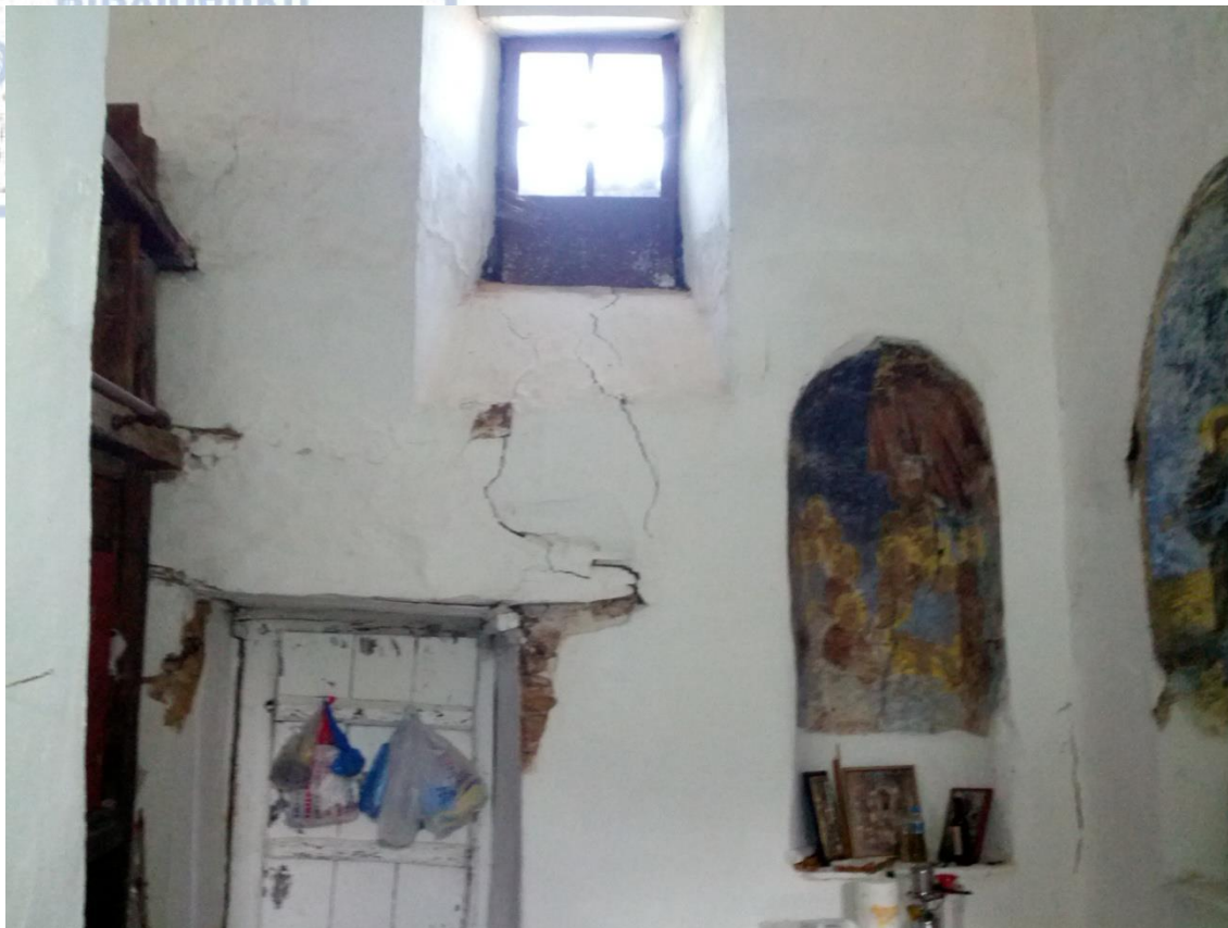
Εικόνα 4: Αποψη του εσωτερικού του ναού με τις ρωγμές που δημιουργήθηκαν από τα ερπυστικά φαινόμενα
