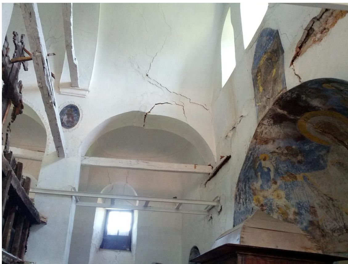
Εικόνα 5: Αποψη του εσωτερικού του ναού με τις ρωγμές που δημιουργήθηκαν από τα ερπυστικά φαινόμενα
