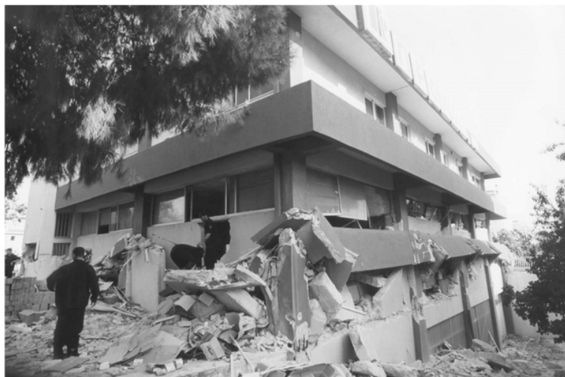
Τυπική δομική αστοχία κτιρίου στις Αδάμες.
