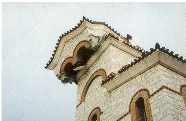
Φωτ. 4.1. Δομικές βλάβες σε εκκλησία του δήμου Άνω Λιοσίων.
