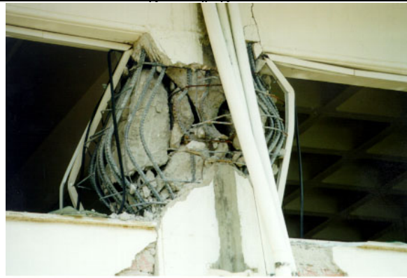
Τυπική αστοχία κοντού υποστυλώματος.
