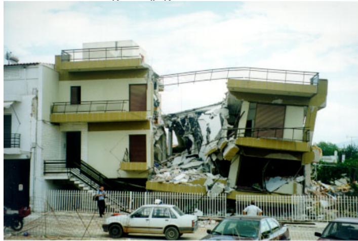
Μερική κατάρρευση 3ώροφης κατοικίας από σπλισμένο σκυρόδεμα. Μενίδι.
