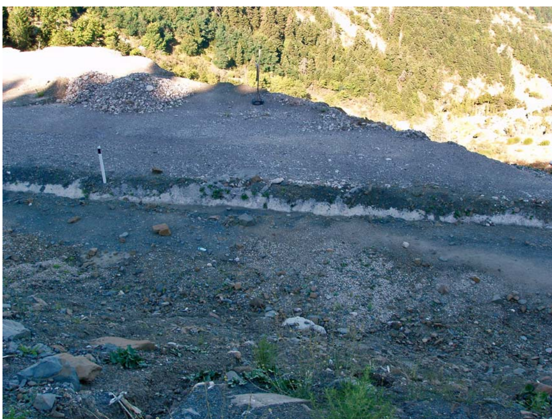
Υποχώρηση του εδάφους κατάντη της Εθνικής Οδού στο νότιο τμήμα της κατολίσθησης.
