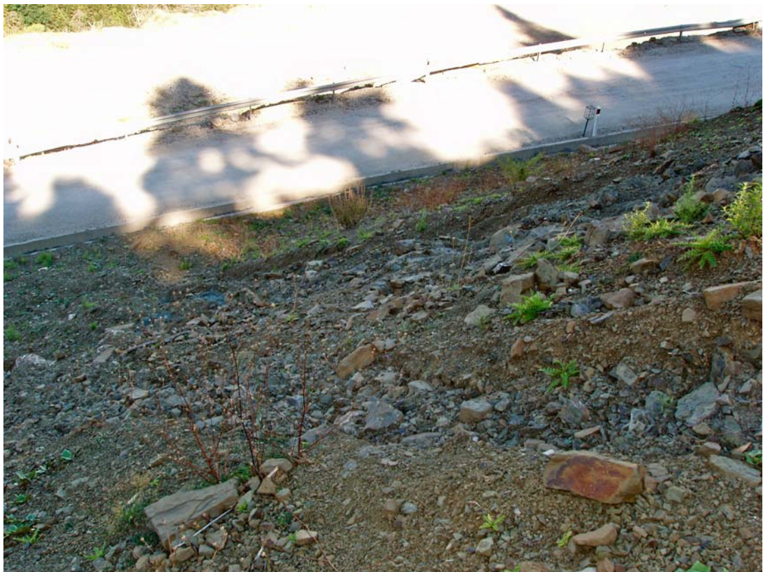
Κοντινή άποψη του πρανούς στο ανατολικό τμήμα της κατολίσθησης.
