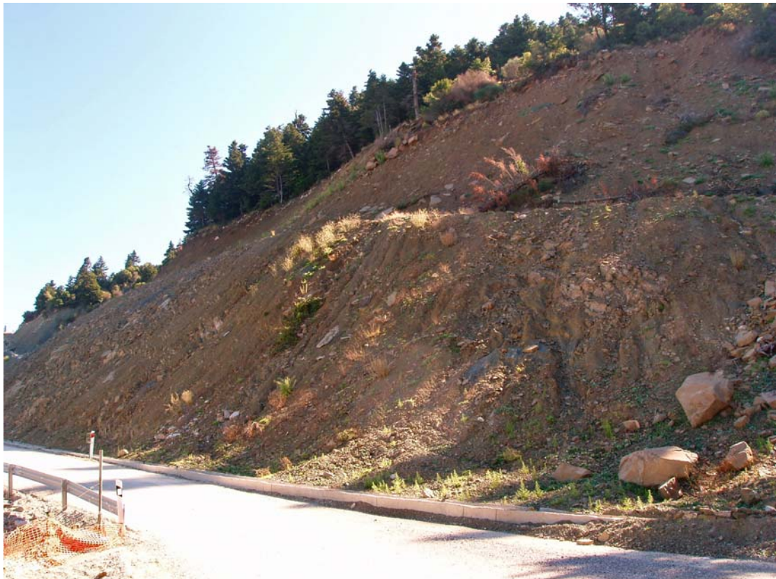
Ανατολικό τμήμα κατολίσθησης.
