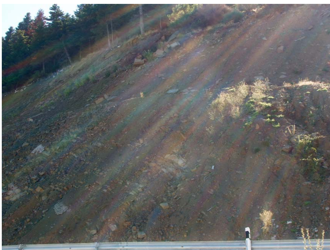
Άποψη του πρανούς στη δυτική πλευρά της κατολίσθησης.
