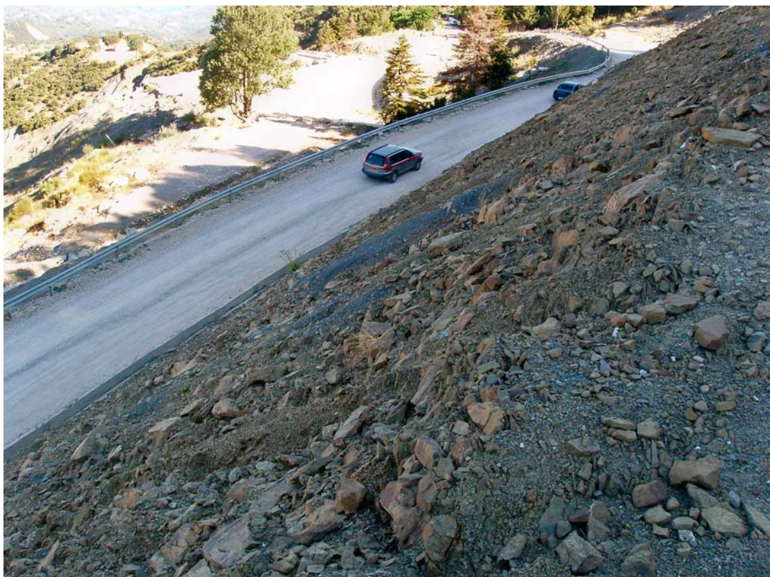
Αποψη του κεντρικού τμήματος της κατολίσθησης.
