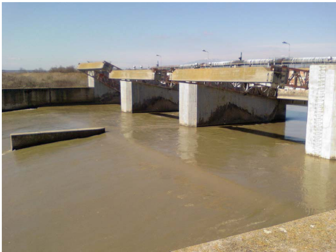
Σχήμα 3.2: Φωτογραφία του φράγματος. Διακρίνονται τα τρία από τα τέσσερα θυροφράγματα.
