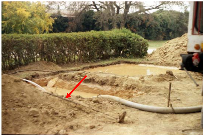
Εικόνα 13 . Οι δυο αρχικές δεξαμενές πολτού, όπου φαίνεται η επικοινωνία τους
