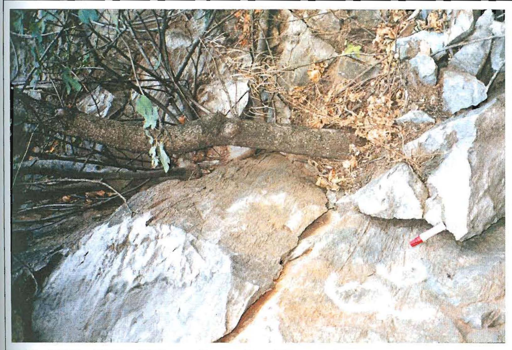
Φωτ.3. Στην περαιτέρω χαλάρωση του πετρώματος εισβάλλει σημαντικά και το ριζικό σύστημα των δέντρων διευκολύνοντας την απολέπιση αυτού με τη δημιουργία εφελκυστικών τάσεων κατά μήκος των επιφανειών των ασυνεχειών.
