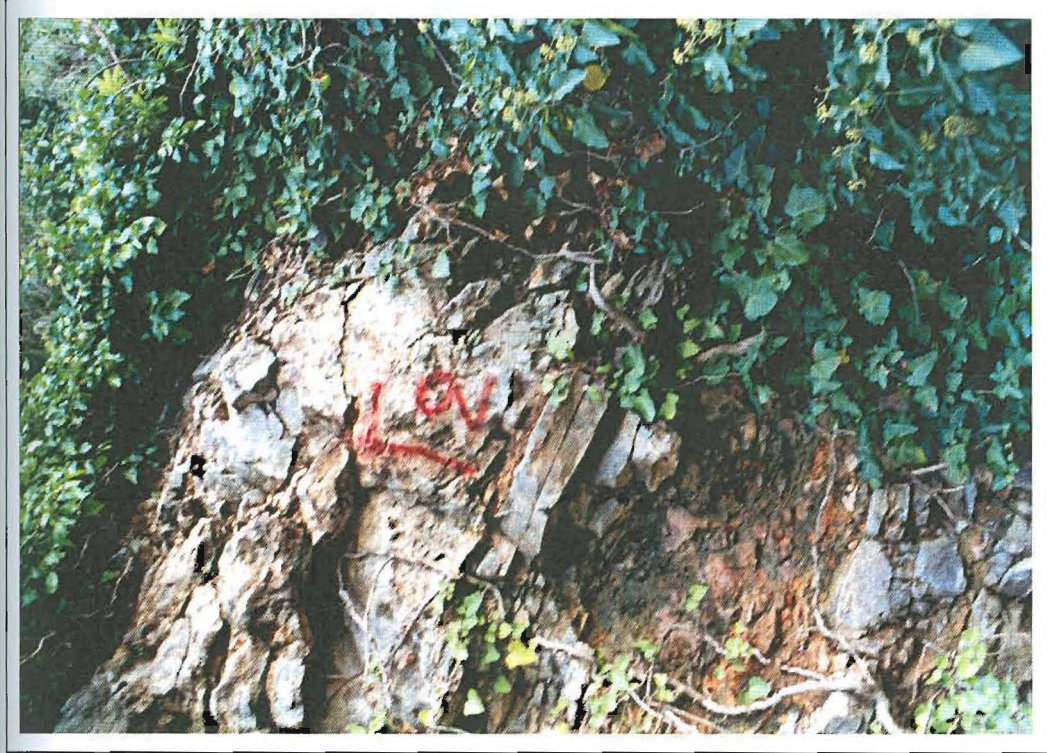
Φωτ.4. Έντονα κερματισμένο και αποσαθρωμένο πέτρωμα. Η βραχομάζα λόγω του θρυμματισμού και εξαλλοίωσης συμπεριφέρεται σαν εδαφομάζα.
