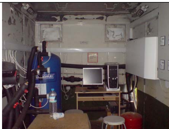
Γενική εσωτερική άποψη του χώρου της αντλίας θερμότητας (Πηγή:Προσωπικό αρχείο)
