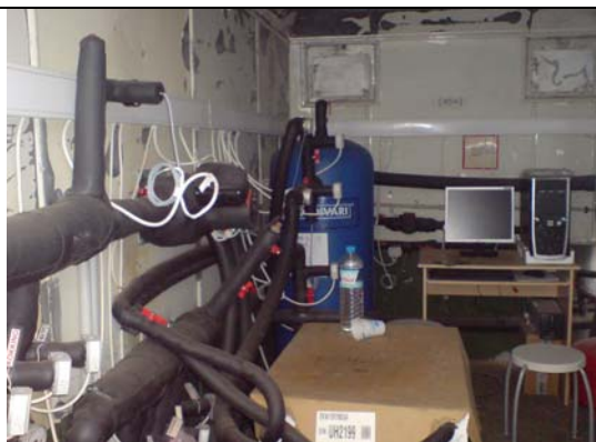
Γενική εσωτερική άποψη του χώρου της αντλίας θερμότητας (Πηγή:Προσωπικό αρχείο)
