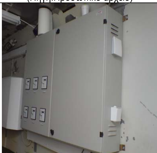
Γενική εσωτερική άποψη του χώρου της αντλίας θερμότητας - διάφορες συνδέσεις (Πηγή:Προσωπικό αρχείο)
