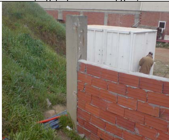
Χώρος τοποθέτησης αντλίας θερμότητας & στοιχεία της (Πηγή:Προσωπικό αρχείο)
