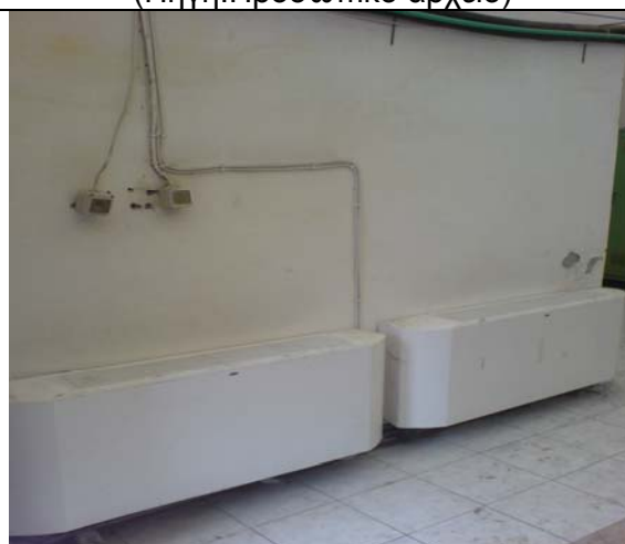
Φαν coils τοποθετημένα στο διπλανό κτίριο για παροχή θέρμανσης στα αποδυτήρια των εργαζομένων της εταιρείας Χριστοδουλίδη (Πηγή:Προσωπικό αρχείο)
