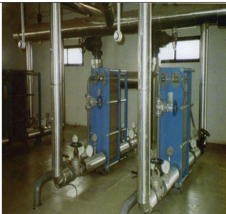
Σχήμα A12 Πλακοειδείς εναλλάκτες θερμότητας (Γεωθερμικό πεδίο Ν. Κεσσάνης Ξάνθης) (Πηγή: Ελληνική τράπεζα βιομηχανικής αναπτύξεως)
