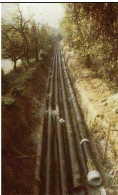
Σχήμα A11 Σωλήνες μεταφοράς γεωθερμικών ρευστών (Πηγή: Ελληνική τράπεζα βιομηχανικής αναπτύξεως)
