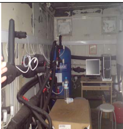
Γενική εσωτερική άποψη του χώρου της αντλίας θερμότητας (Πηγή:Προσωπικό αρχείο)
