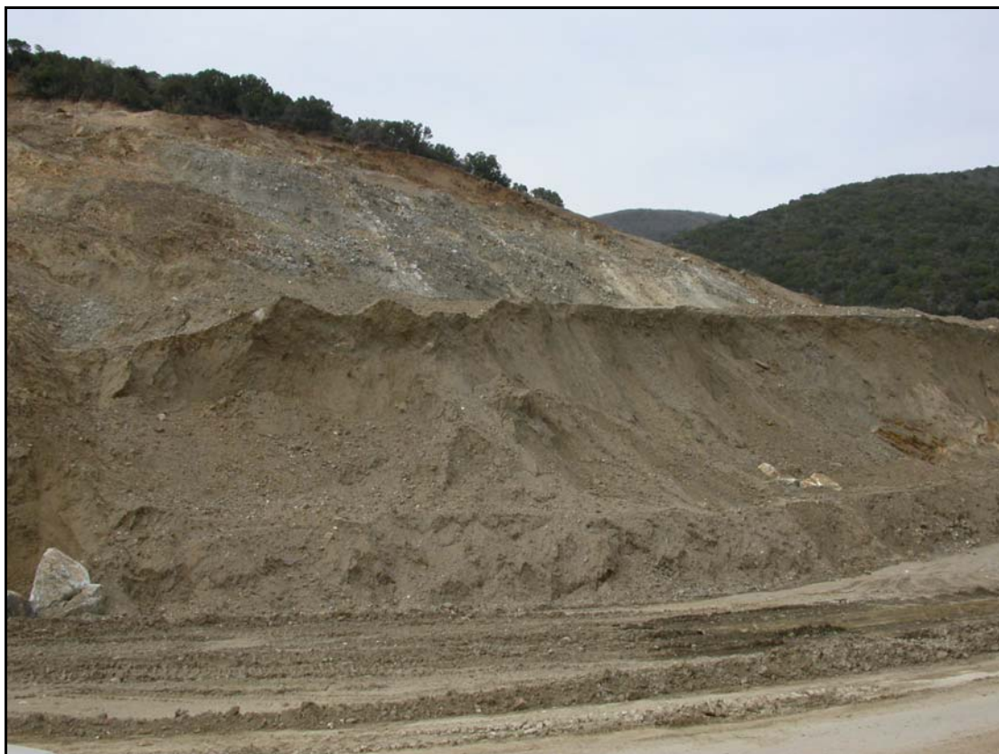
Εικόνα 7.4. Ολική κατάρρευση των αναβαθμίδων. Σημερινή κατάσταση (Σεπτέμβριος 2003)
