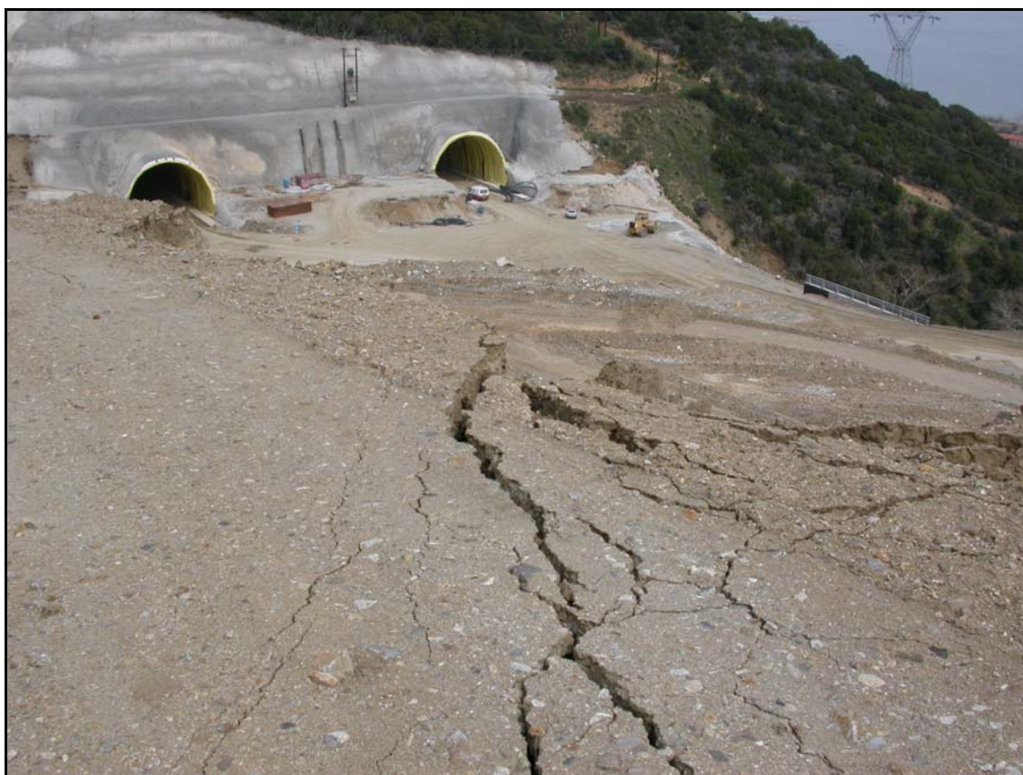
Εικόνα 7.7. Εφελκυστικές ρωγμές πάνω στις αναβαθμίδες.
