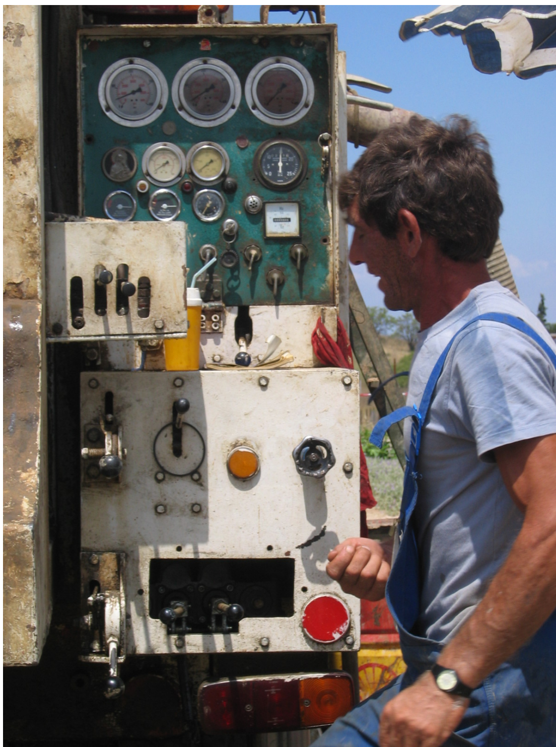
Εικόνα 7. Πίνακας ελέγχου γεωτροπάνου
