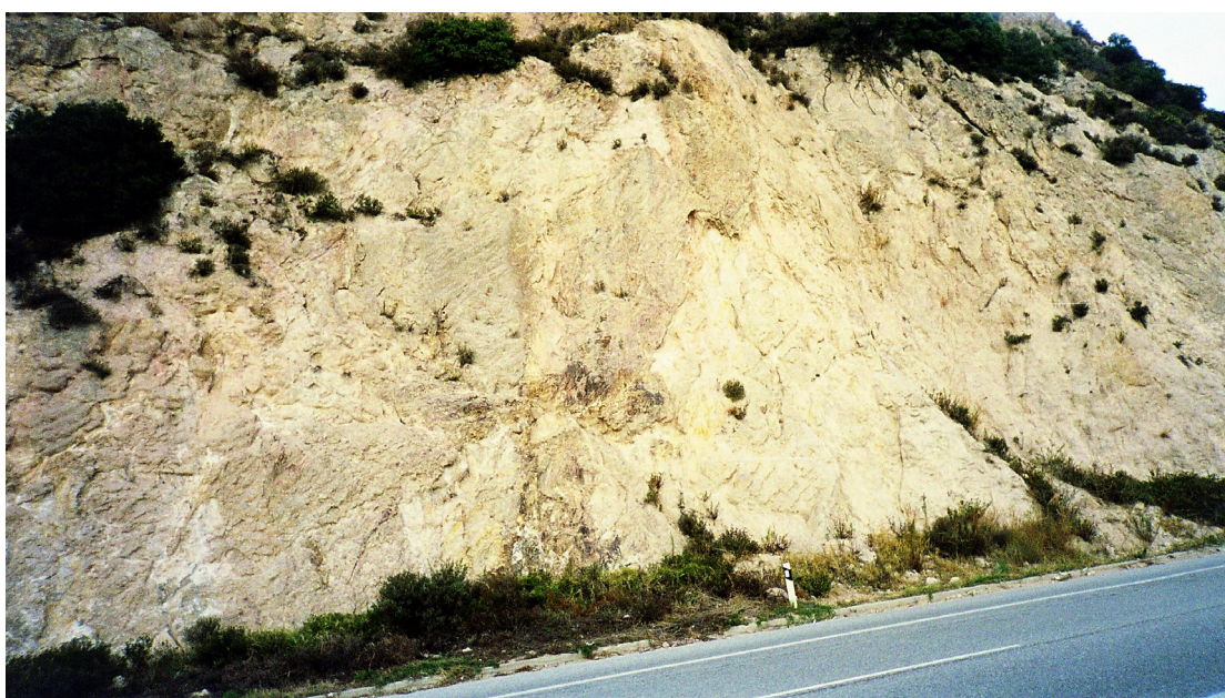
Φωτ. 10 : Ανατροπή βράχων στη θέση 11 της περιοχής των Λουτρών Ελευθερών. Στη φωτογραφία φαίνεται η επιφάνεια ολίσθησης.
