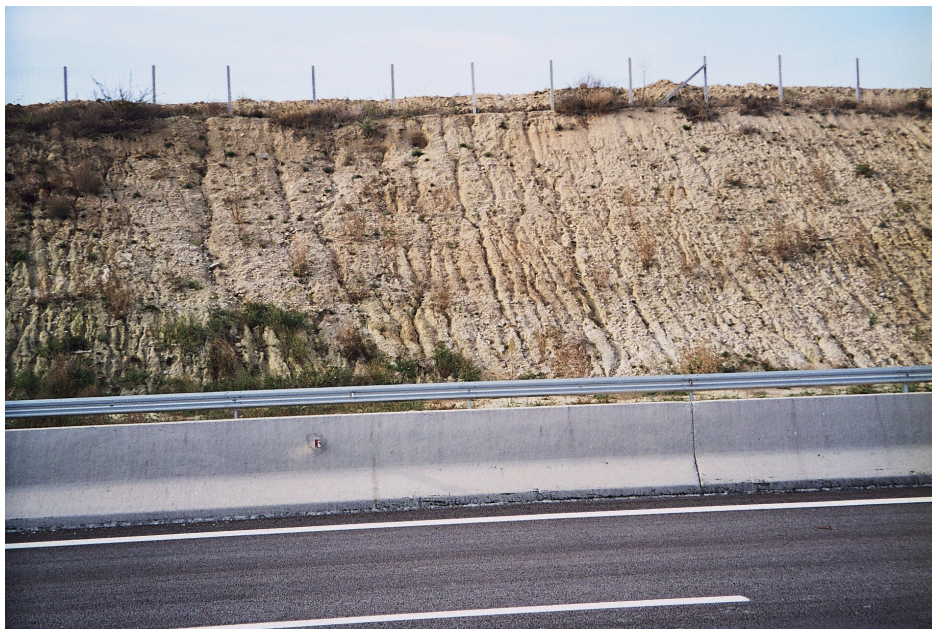
Φωτ. 8 : Ροή κορημάτων στη θέση 9 της περιοχής Ασπροβάλτα – Στρυμόνα. Στη βάση της κατολίσθησης έχει κατασκευαστεί τοιχίο αντιστήριξης.
