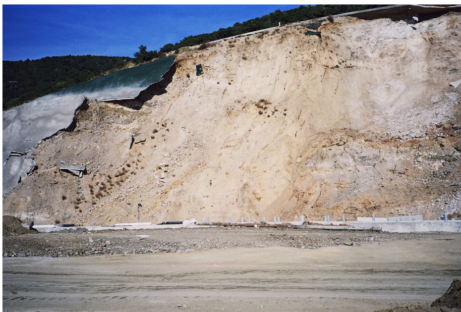
Φωτ. 1 : Κατολίσθηση στον υπό κατασκευή δρόμο της Εγνατίας Οδού, στην περιοχή Ασπροβάλτα – Στρυμόνα.
