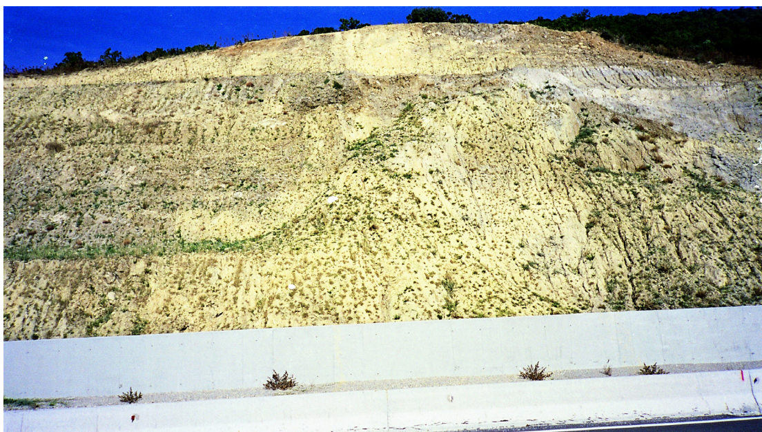
Φωτ. 3 : Ολίσθηση κορημάτων στη θέση 2 της περιοχής Ασπροβάλτας – Στρυμόνα. Στη βάση της κατολίσθησης έχει κατασκευαστεί τοιχίο αντιστήριξης.
