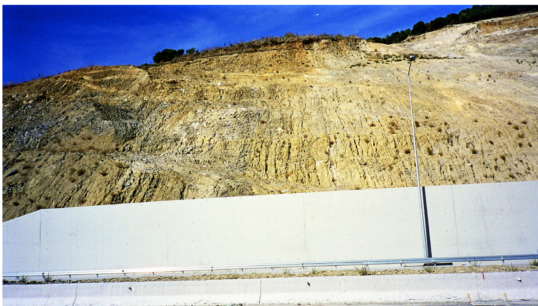
Φωτ. 4 : Ολίσθηση κορημάτων στη θέση 3 της περιοχής Ασπροβάλτας – Στρυμόνα. Στη βάση της κατολίσθησης έχει κατασκευαστεί τοιχίο αντιστήριξης.
