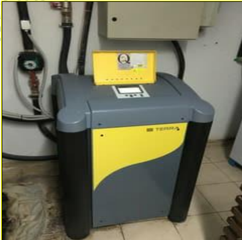
Εικόνα 27. Η μικρή αντλία θερμότητας TERRA SW 30 ( 30 kW ), η οποία χρησιμοποιείται μόνο για παροχή ζεστού νερού.
