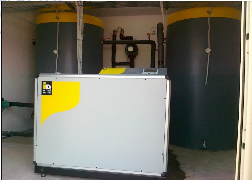
Εικόνα 15. Αντλία θερμότητας για θέρμανση- ψύξη.
