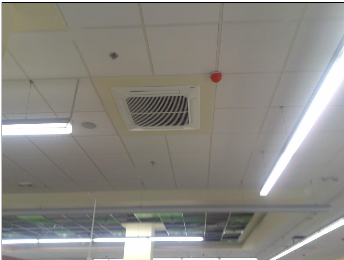
Εικόνα 22. Αερόθερμα Fan Coils νερού οροφής για θέρμανση – ψύξη στο κατάστημα ΜΕΤΡΟ.
