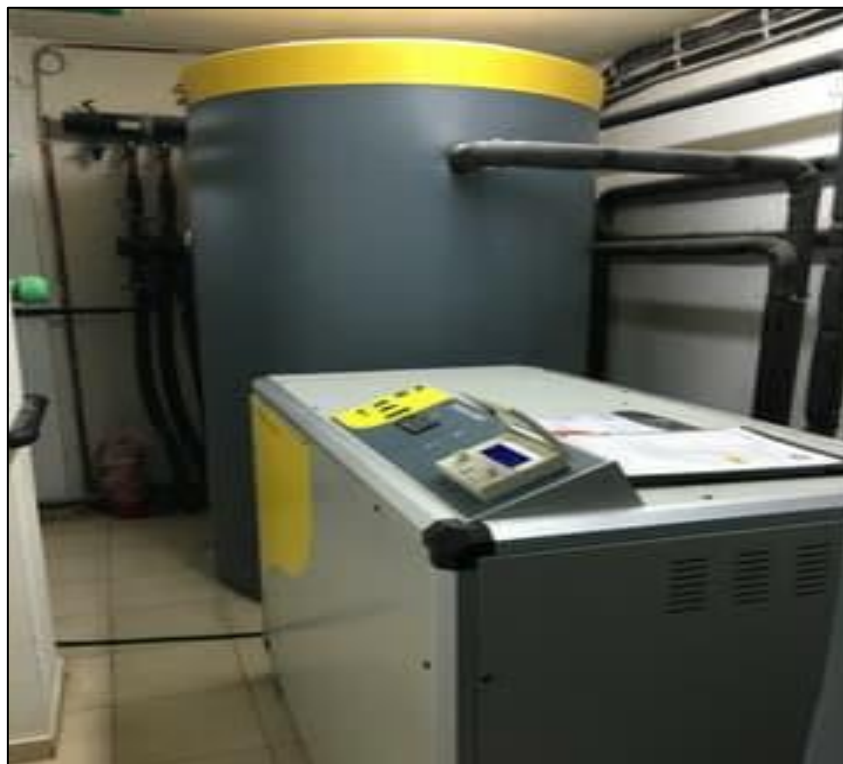
Εικόνα 28. Η μεγάλη αντλία θερμότητας TERRA MAX 70 ( 70 kW ), η οποία χρησιμοποιείται για θέρμανση – ψύξη.
