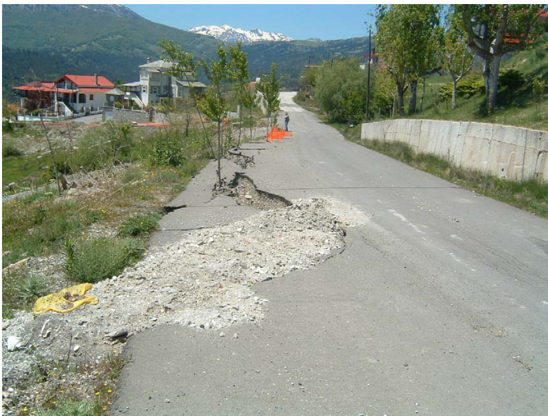
Φωτο Π.7: Αστοχία σε οδόστρωμα, εντός του οικισμού των Φιλιππαίων (πηγή: ΑΝ.ΚΟ. Α.Ε.).
