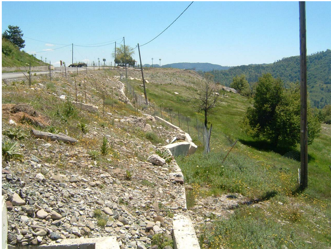
Φωτο Π.8: Αστοχία σε τοιχείο, εντός του οικισμού των Φιλιππαίων (πηγή: ΑΝ.ΚΟ. Α.Ε.).
