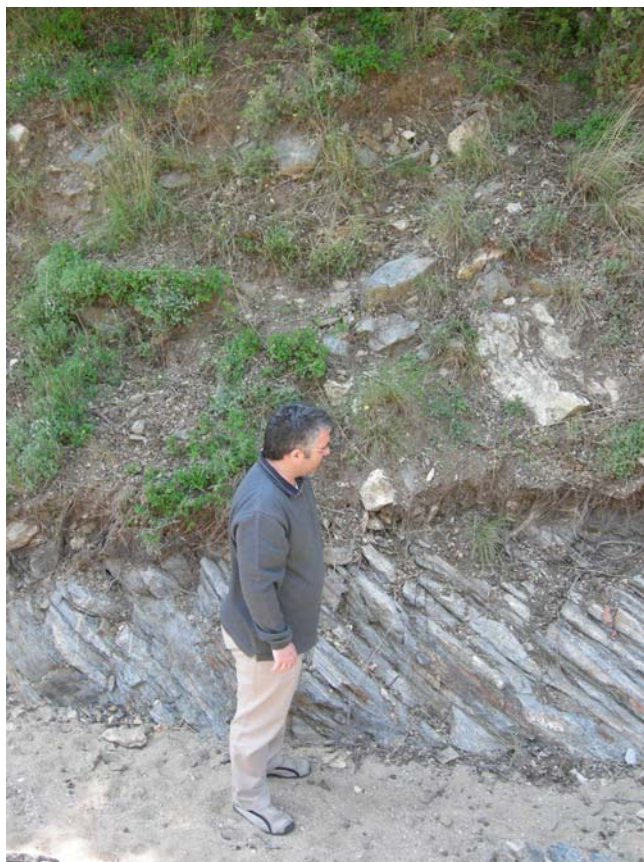
Φωτ. 6 Διάβρωση του μανδύα αποσάθρωσης και αποκάλυψη του υγιούς πετρώματος.
