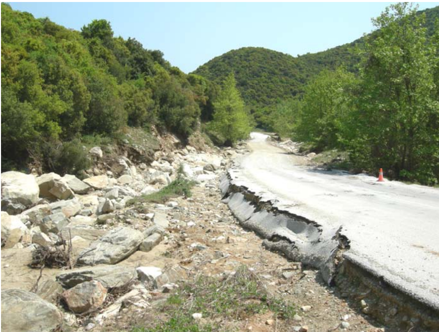
Φωτ. 4 Ζημιές στο οδικό δίκτυο στα ανάντη.
