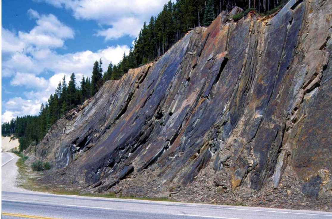
Φωτο 3.8: Πρανές με επιφάνειες ομόρροπες προς αυτό επιφάνειες σχιστότητας, οι οποίες οδηγούν σε ολίσθηση κατά τα επίπεδα σχιστότητας. http://cgc.mcan.gc.ca/landslides
