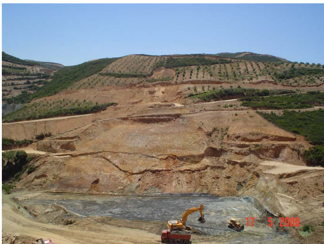
Φωτ. 2: Γενική άποψη του δεξιού αντερείσματος και μεγάλου τμήματος της κοίτης. Στη βάση διακρίνονται ανοιχτές ρωγμές κατά μήκος της εκσκαφής και στην κορυφή η υψηλή κατολίσθηση.
