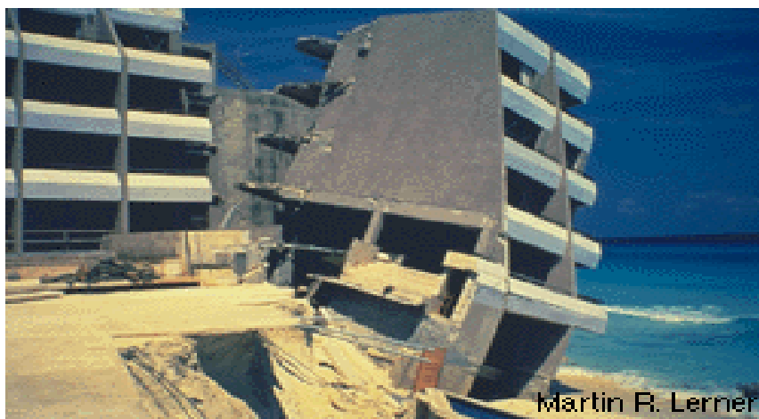
Καταστροφή κατασκευής από εκτεταμένο χτύπημα κυμάτων
