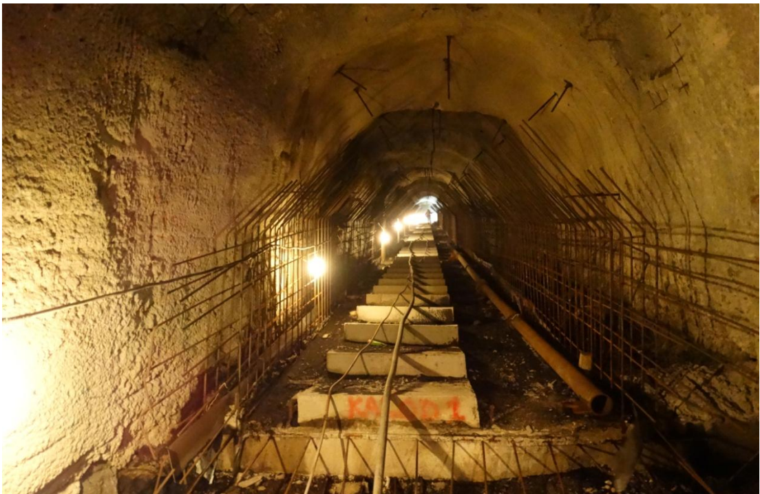
Φωτογραφία 2.6. Κεκλιμένη σήραγγα καλωδίων και διαφυγής (λήψη από σήραγγα προσπέλασης)
