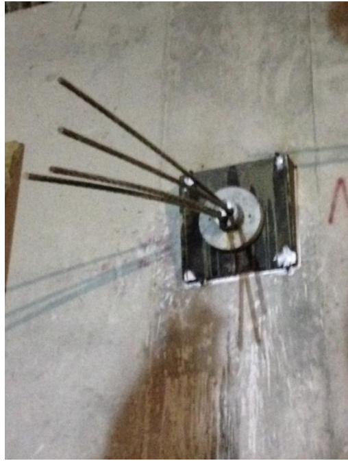
Φωτογραφία 7.12. Κεφαλή προεντεταμένου αγκυρίου, τοποθετημένο με ανοδική κλίση σε τοίχωμα του σταθμού
