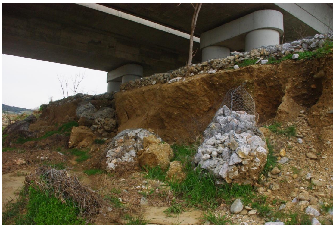
Φωτ.14. Αστοχία των μέτρων αντιστήριξης του ανατολικού πρανούς του χειμάρρου Σχολαρίου, στη θέση από όπου διέρχεται η Εγνατία Οδός (Ημ. Λήψης: 15/03/2015)
