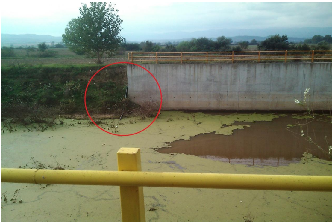
Φωτ.17. Αστάθεια στο νότιο πρανές της ενωτικής τάφρου, ανατολικά του τοιχίου αντιστήριξης (Ημ. Λήψης: 03/10/2014)
