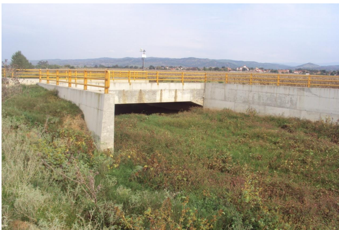
Φωτ.16. Η διώρυγα διαχείρισης όπως φαίνεται σήμερα. Διακρίνεται ξεκάθαρα η πλήρωση της κοίτης με φερτά υλικά (Ημ. Λήψης: 03/10/14)
