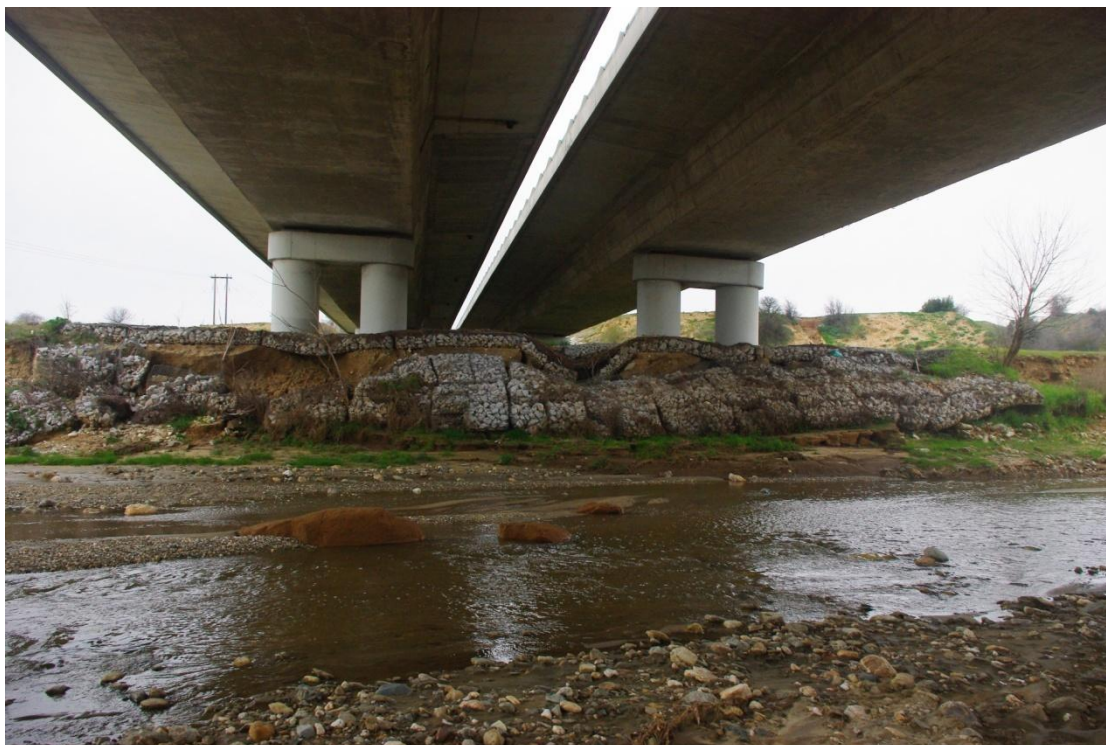
Φωτ.13. Αστοχία των μέτρων αντιστήριξης του ανατολικού πρανούς του χειμάρρου Σχολαρίου, στη θέση από όπου διέρχεται η Εγνατία Οδός (Ημ. Λήψης: 15/03/2015)
