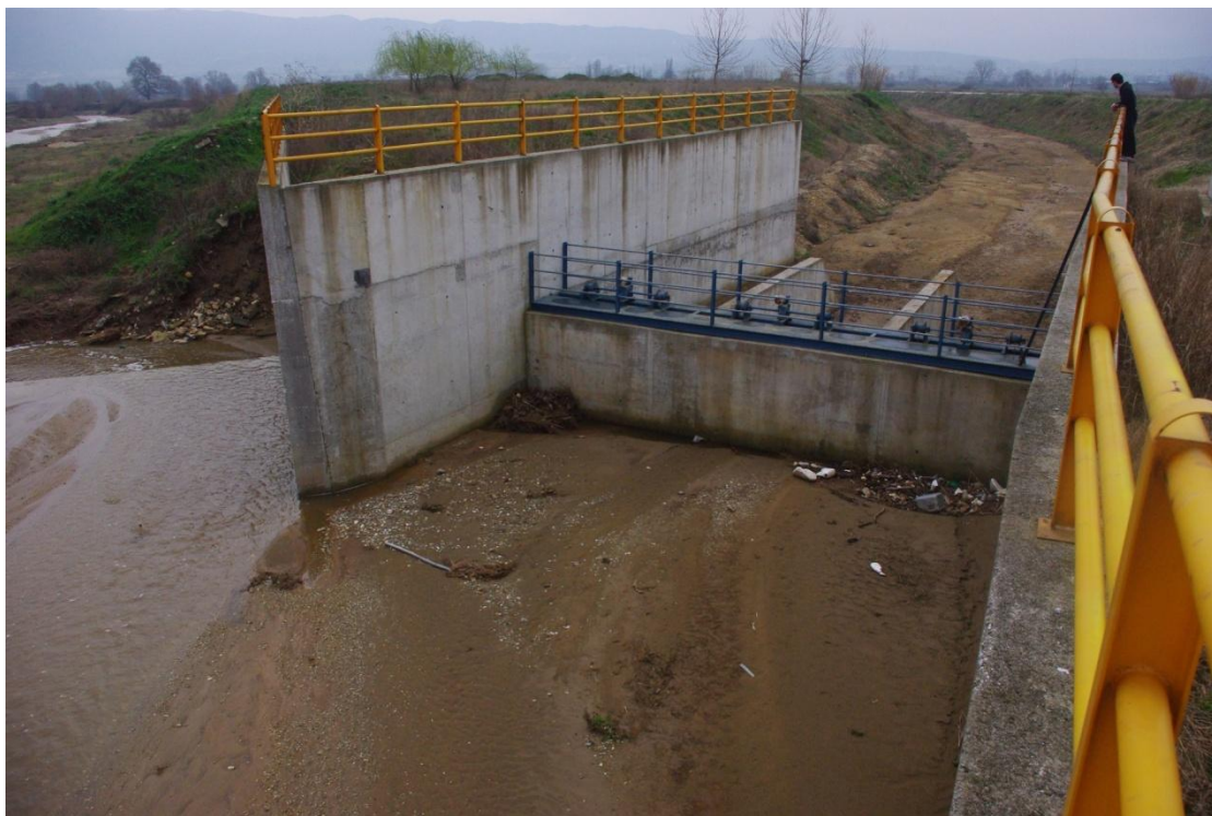
Φωτ.9. Ρουφράκτης μεταξύ του χειμάρρου Σχολαρίου και της διώρυγας διαχείρισης, στο βάθος (Ημ. Λήψης: 01/03/2015)
